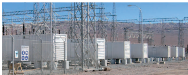
Figura 3 – Subestação com suporte de armazenamento de energia com baterias de iões de lítio (12MW) [21]
