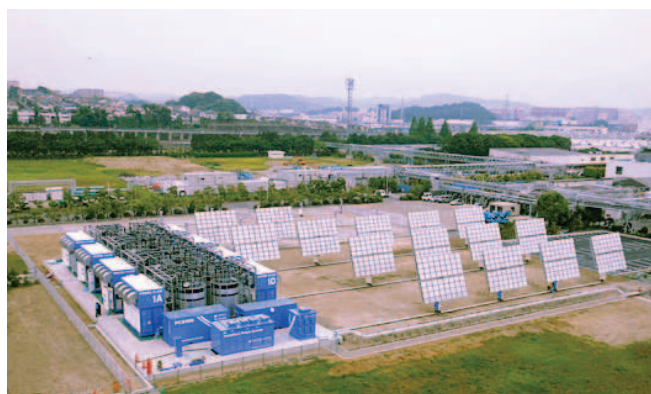
Figura 5 – Aplicação de baterias Redox Vanádio numa central fotovoltaica (60 MWh) [23]
