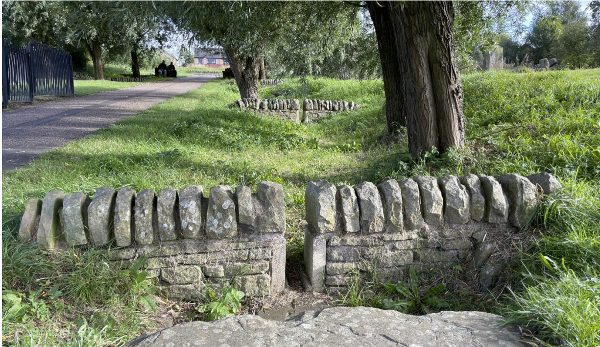
Bilde 40. En terskel-konstruksjon i Manor Fields park. Når det bøtter ned, er det plass til overvannet som strømmer på.
