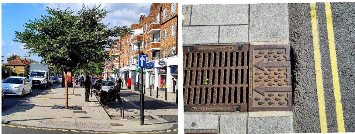
Bilde 52. Rotkassene til disse trærne strekker seg under bilparkeringsplassen til høyre, som også har et semipermeabelt dekke. Høyre bilde viser inntak til rotkasse med renseslum langs veibanen. Bloemfontein Rd. Shepherds Bush, https://maps.app.goo.gl/K5o8wMZ4jRtExtKK7 .
