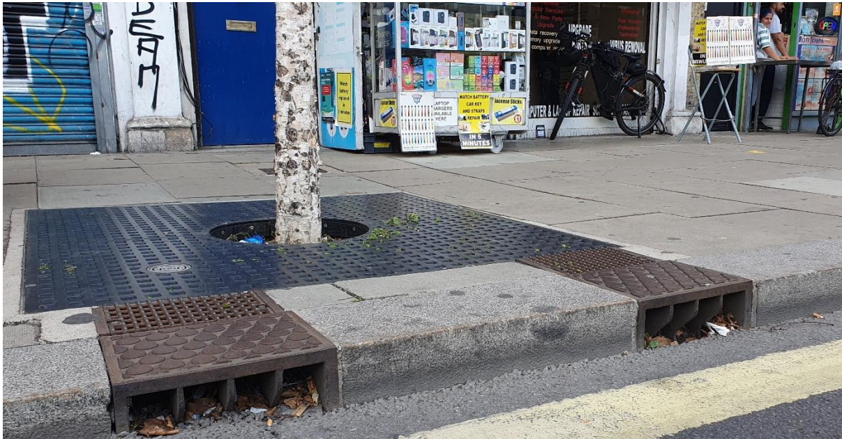
Bilde 50. Solide innløpsrister sender gatevann mot treet og forsterkingslaget det står plantet i.
