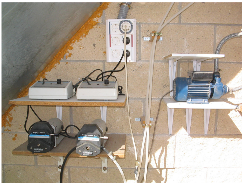
Fotografía 6-15. Bombas de alimentación y recirculación
