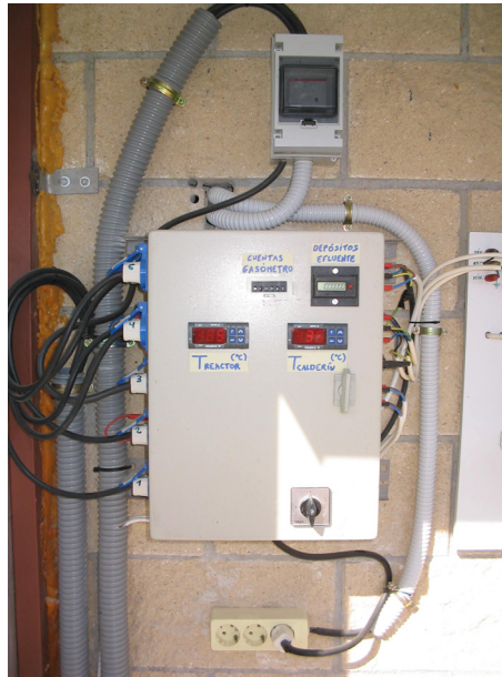
Fotografía 6-19. Vista exterior del cuadro eléctrico
