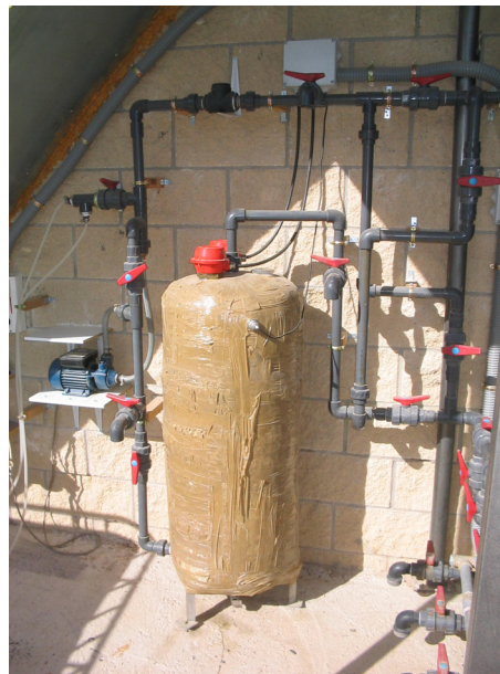
Fotografía 6-17. Calderín de calefacción
