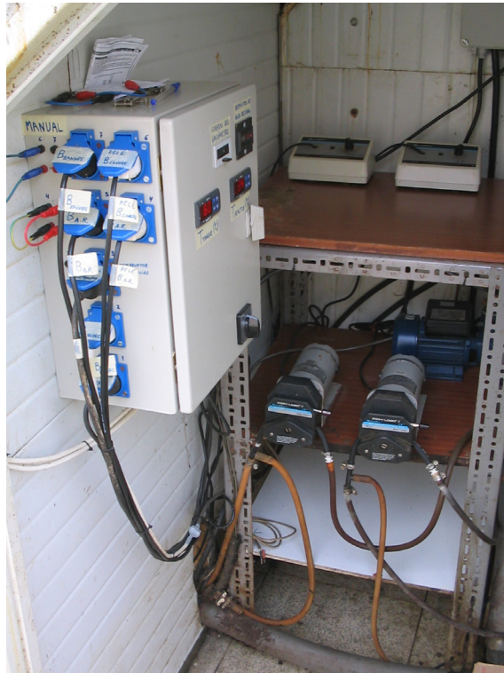
Fotografía 5-3. Interior de la caseta de control
