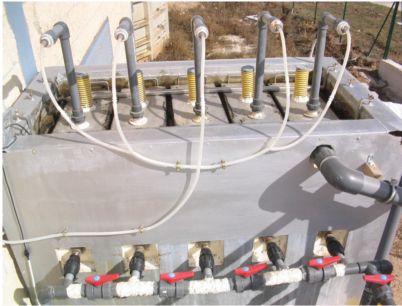
Fotografía 6-7. Sistema de recogida de biogás
