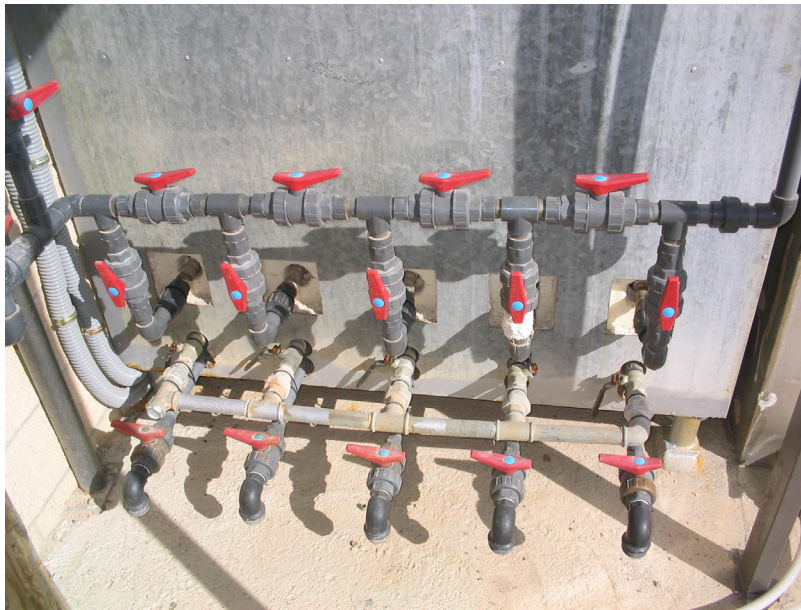
Fotografía 6-16. Sistema de distribución de la alimentación en el BAPF
