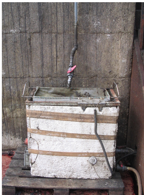
Fotografía 5-1. Tanque de precalefacción
