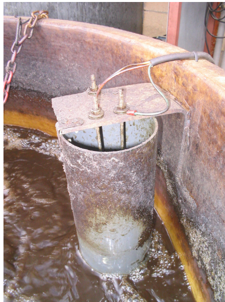
Fotografía 8-1. Control de nivel con tranquilizador
