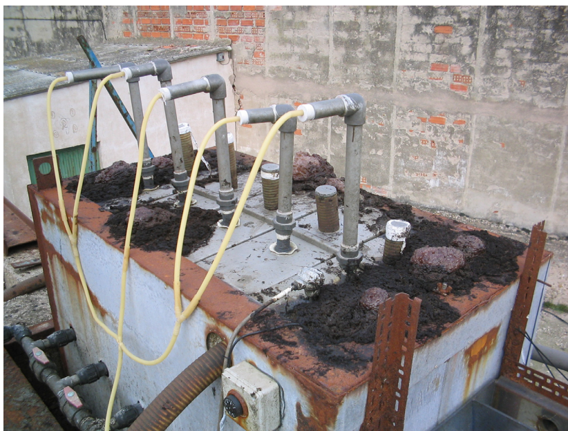
Fotografía 5-4. Pérdida puntual de biogás de las campanas
