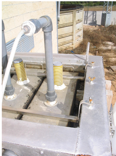
Fotografía 6-5. Campana de recogida de biogás
