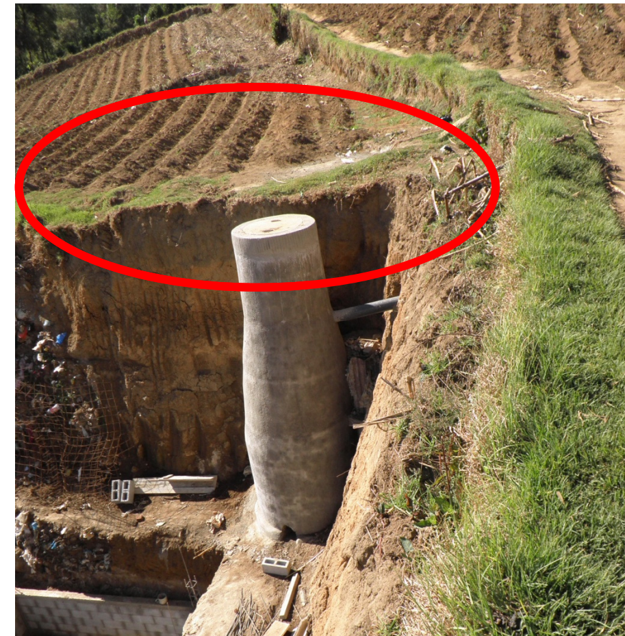
Inexistencia de vallado perimetral de protección contra caídas a distinto nivel.
