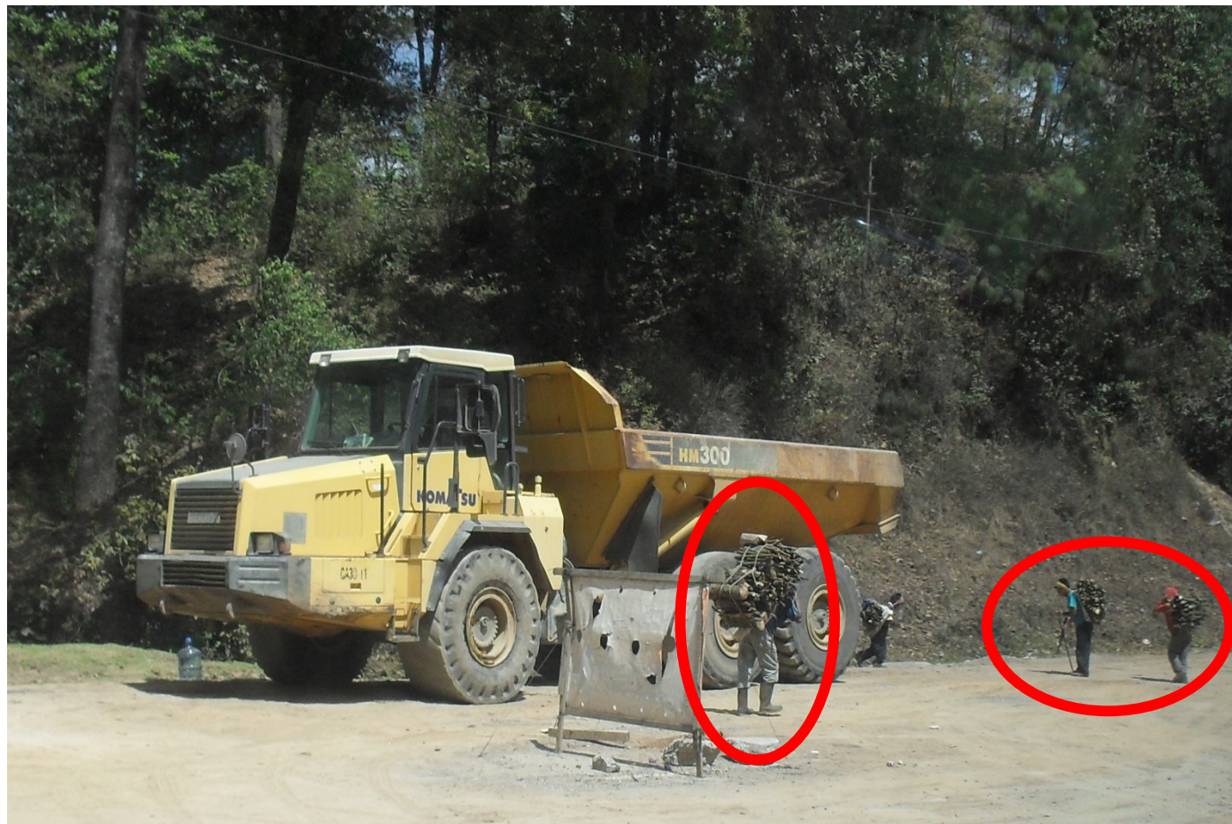
Tránsito de personas ajenas a la obra, con riesgo de atropello por la maquinaria pesada.
