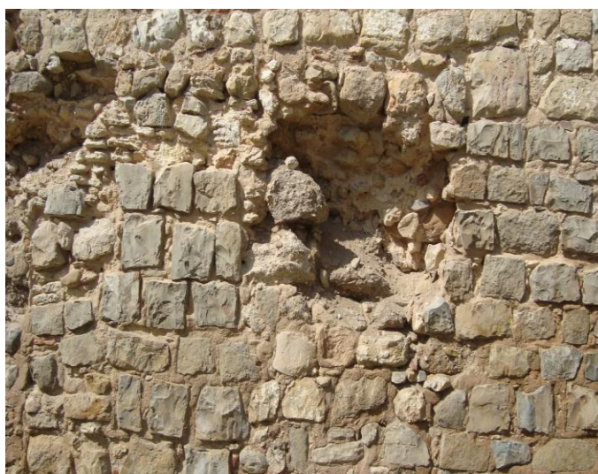
Figura 3.6 - Degradação provocada por agentes erosivos.
