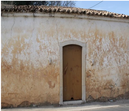
Figura 3.3 - Fendilhação nas zonas dos vãos.
