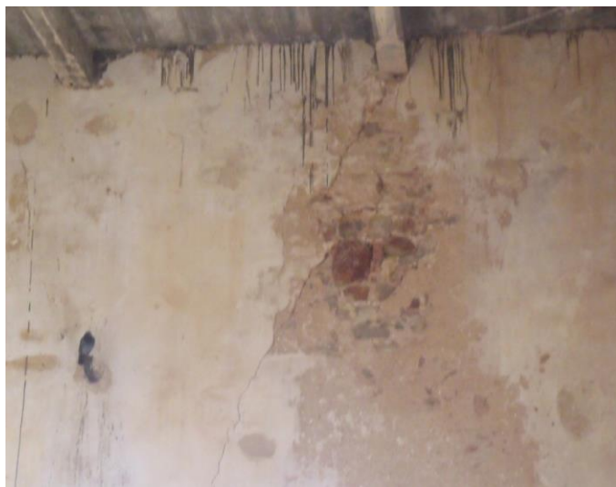
Figura 3.5 – Fissura na direção da viga.
