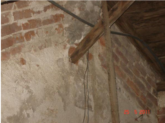
Figura 66 - Acrescentos na parede frontal por cima da porta principal. Foto do autor, 2011
