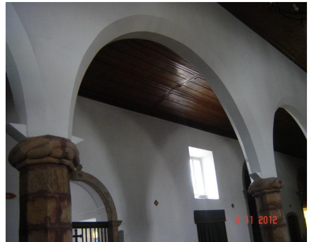
Figura 51 - Arco formeiro de volta perfeita e chanfrado, em alvenaria Foto do autor, 2012
