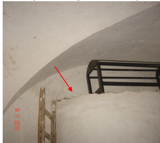
Figura 92 - Aspecto do contraforte no interior da arrecadação por baixo da capela mor. Foto do autor, 2010
