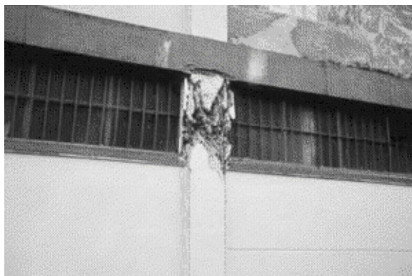
Figura 1: Rotura frágil de um pilar devido ao preenchimento parcial da estrutura.
