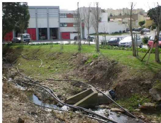
Figura 33 – Presença de tubagens no leito da linha de água. Fonte: Autor. 2010.
