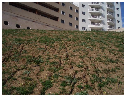
Figura 41 – Abertura de sulcos no solo causada por agentes de erosão. Fonte: autor.2010.
