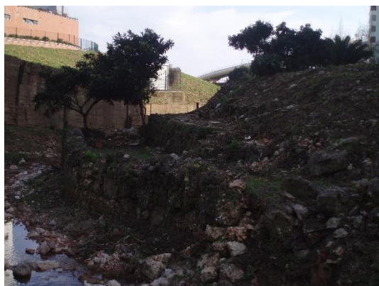
Figura 47 – Muro em alvenaria de pedra na margem da linha de água. Fonte: autor.2010.
