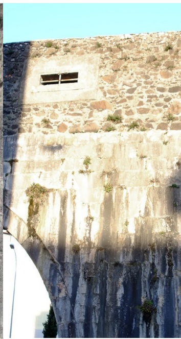
Figura 18 Pormenor da arcaria e da entrada de luz na Reboleira. Fotografia tirada pelo candidato.
