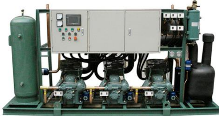
Ilustración 16 - Rack de compresores
