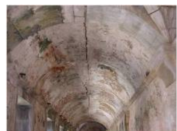
Figura 189 – Fendas longitudinais nas abóbadas de berço da ala sul, segundo nível, Mosteiro das Salzedas [Lourenço, Paulo B. et al (2008)]
