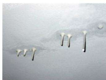
Figura 177 – “Estalactites” devido a infiltrações através de fenda em laje da cobertura
