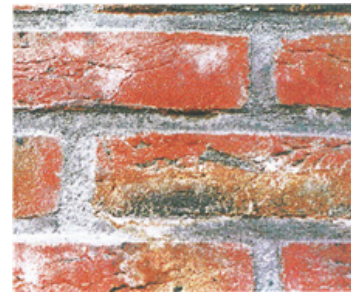
Figura 196 – Manchas em alvenaria cerâmica [Franke, L. et al (1998)]
