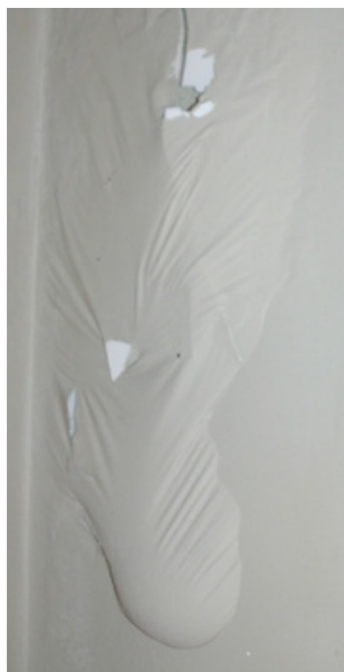
Figura 220 – Empolamento de revestimentos devido à presença de água no interior de paredes, Condomínio Pátio Lencastre, Lisboa
