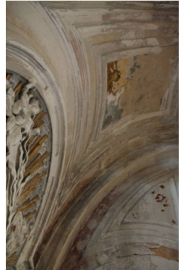
Figura 252 - Humidade em estuques de gesso, Igreja do Convento do Sacramento, século XVII-XIX
