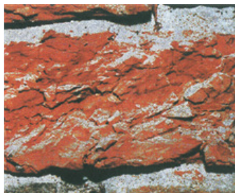
Figura 205 – Esboroamento alvenaria cerâmica [Franke, L. et al (1998)]
