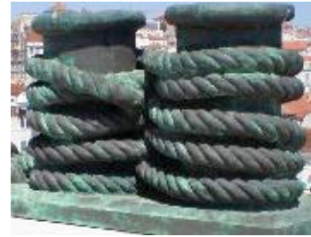
Figura 339 - Corrosão em elementos metálicos [Atelier 15 (2011)]
