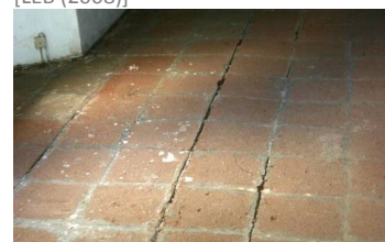
Figura 397 – Fendilhação no pavimento - zona sul do edifício A [LEB (2008)]
