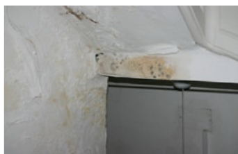
Figura 215 – Eflorescências em paredes interiores, Condomínio Pátio Lencastre, Lisboa [Foto LEB]
