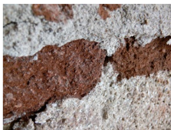
Figura 130 - Argamassa de assentamento em parede de alvenaria, Casa das Almeidas [Foto LEB]
