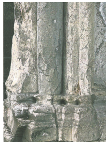
Figura 203 – Fenómenos de lascagem, Sé Velha de Coimbra
