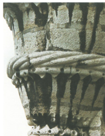
Figura 201 – Crostas negras e zonas lavadas por escorrência, Torre de Belém, Lisboa
