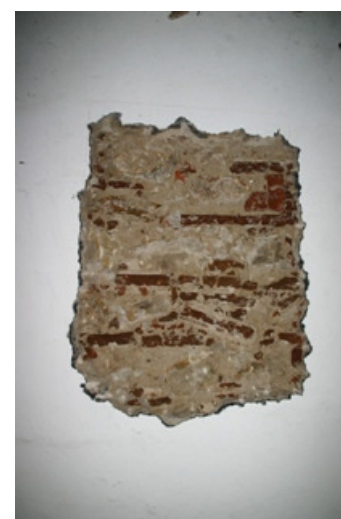
Figura 85 – Abertura de janela de inspeção e ensaios, Ex Celeiros EPAC, Évora [Foto LEB]
