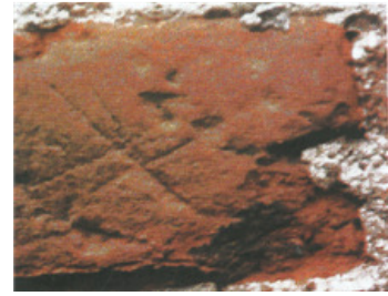
Figura 213 – Risco em alvenaria cerâmica
