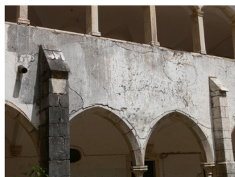
Figura 358 - Depósitos de sujidade e manchas em revestimentos [LEB (2010a)]
