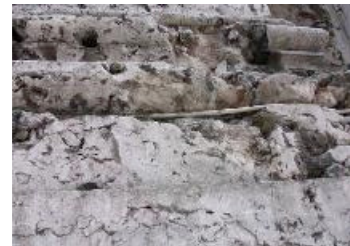
Figura 332 - Erosão, superfície fortemente erodida [Atelier 15 (2011)]
