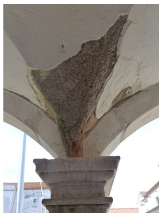
Figura 360 - Destacamento de revestimentos [LEB (2010a)]
