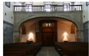
Figura 188 – Abatimento do arco do coro-alto na Igreja de Cascais [Foto LEB]
