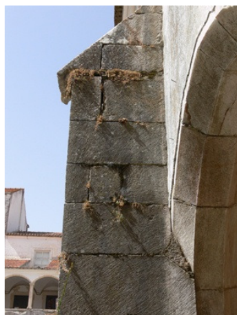
Figura 359 - Depósitos biológicos em contrafortes [LEB (2010a)]
