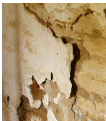
Figura 221 – Perda de ligação do revestimento ao suporte, Casa das Almeidas, Lisboa
