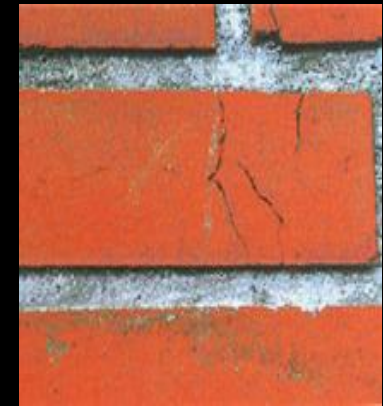
Fendilhação de elementos de alvenaria
