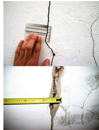
Figura 386 – Medição de fendas com fissurómetro e fita métrica [LEB (2008)]
