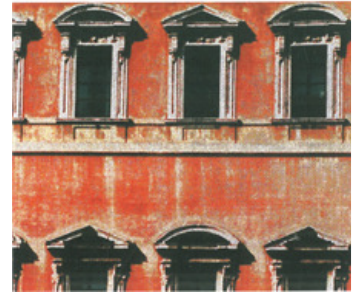
Figura 195 – Perda de cor em alvenaria cerâmica [Franke, L. et al (1998)]
