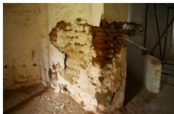
Figura 254 - Revestimento muito degradado cuja reparação e consolidação é inviável
