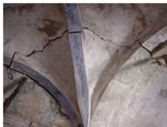
Figura 190 - Fendas nas abóbadas, canto sudoeste, segundo nível, Mosteiro das Salzedas [Lourenço, Paulo B. et al (2008)]
