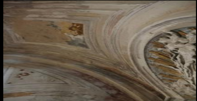
Estuques degradados e posteriormente reparados
