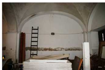
Figura 393 – Manchas de humidade em parede interior [LEB (2008)]
