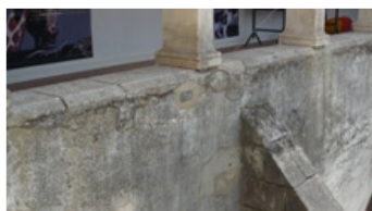
Figura 214 – Depósitos de sujidade em revestimentos, Claustro do Convento das Maltezas em Estremoz [Foto do autor]
