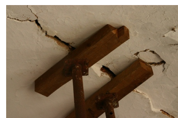
Figura 364 - Deformação com fendilhação em duas direcções das abóbada do primeiro piso [LEB (2010a)]
