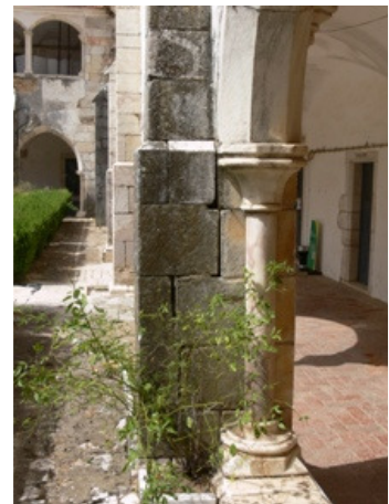
Figura 187 – Inclinação dos Contrafortes, Claustro do Convento das Maltezas em Estremoz [Foto do autor]
