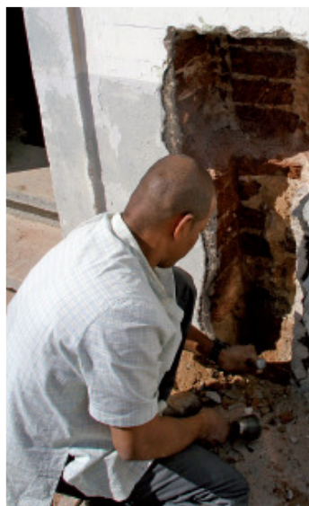
Figura 180 – Alterações para instalação de contadores fragilizando a estrutura
