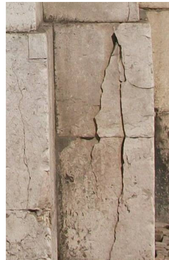
Figura 340 - Fractura com lascagem [Atelier 15 (2011)]
