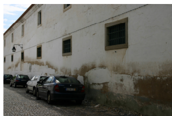
Figura 394 – Manchas de humidade em parede exterior [LEB (2008)]
