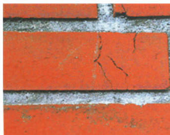
Figura 211 – Fendilhação não estrutural em elementos de alvenaria [Franke, L. et al (1998)]
