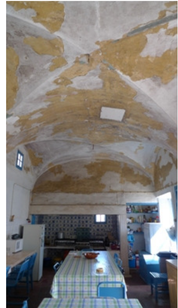
Figura 178 – Deterioração de revestimentos associada a humidades de condensação e de precipitação, Convento das Maltezas, Estremoz [Foto do autor]
