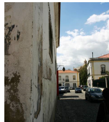
Figura 396 – Deformação em paredes de alvenaria [LEB (2008)]
