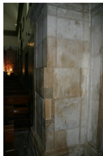
Figura 194 – Abatimento do arco do coro-alto na Igreja de Cascais [Foto LEB]
