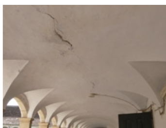
Figura 191 – Fendilhação das abóbadas do piso superior, Claustro do Convento das Maltezas em Estremoz [Foto do autor]
