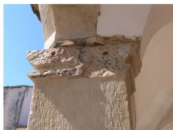
Figura 361 - Elementos fissurados ou com lacunas [LEB (2010a)]
