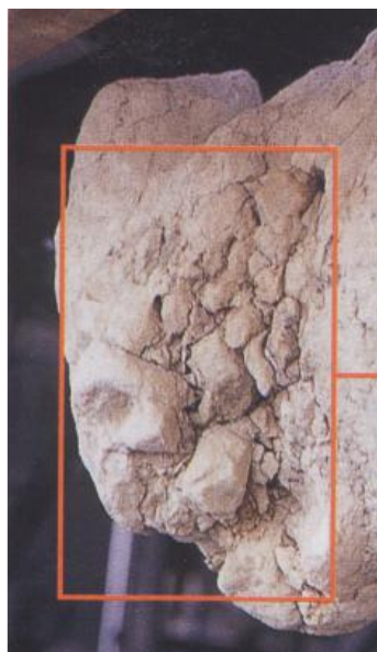
Figura 281 – Cachorro na Torre de Belém antes da intervenção com consolidantes
