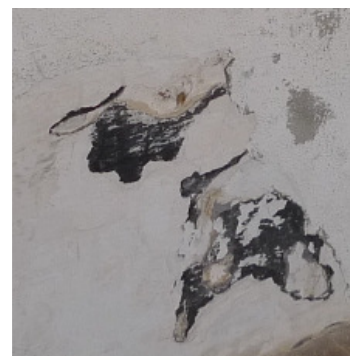
Figura 219 – Exfoliação de revestimento, Claustro do Convento das Maltezas em Estremoz [Foto do autor]
