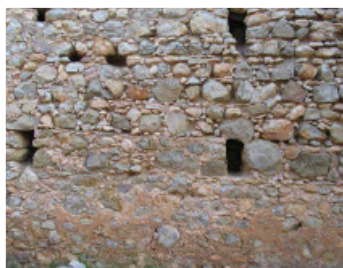
Figura 132 - Exemplos de marcas de andaimes, Ermida do Castelo de Paderne
