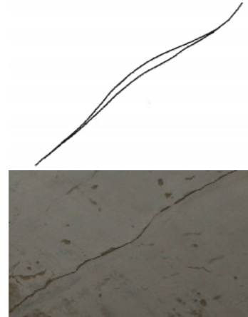
Figura 222 e Figura 223 – Fissuração bem definida com direcção única, Ex-Celeiros EPAC, Évora [Argilés, Josep M. et al (1999c)]
