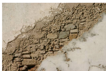
Figura 391 – Destacamento de revestimentos [LEB (2008)]
