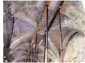
Figura 186 – Separação entre abóbadas e paredes de apoio, Mosteiro das Salzedas [Lourenço, Paulo B. et al (2008)]
