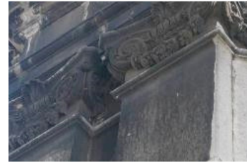
Figura 330 - Depósitos superficiais de sujidade de cor escura [Atelier 15 (2011)]
