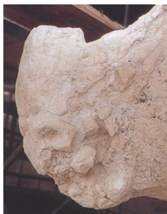
Figura 282 – Cachorro na Torre de Belém depois da intervenção com consolidantes de resinas epóxicas
