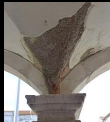
Destacamento de revestimentos
