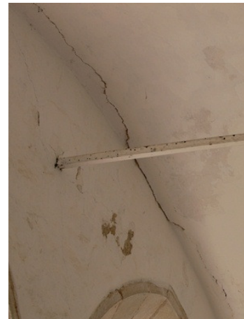
Figura 363 - Fendas orientadas nas abóbadas do primeiro piso junto à fachada [LEB (2010a)]
