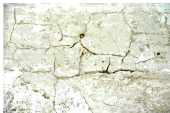
Figura 390 – Fendilhação em paredes de alvenaria [LEB (2008)]
