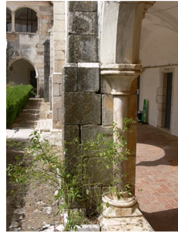
Figura 362 - Juntas abertas ou não funcionais em contrafortes [LEB (2010a)]
