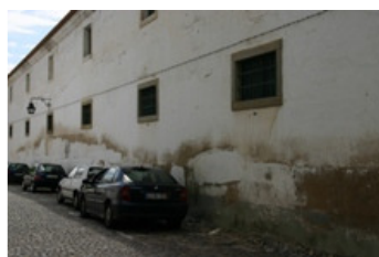
Figura 176 - Manchas de humidade associadas à ascensão capilar de água, Ex Celeiros EPAC, Évora
