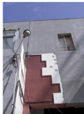
Figura 234 – Porto, obras de reabilitação e conclusão do conjunto habitacional da Bouca: colocação de isolamento térmico pelo exterior
