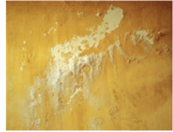
Figura 182 – Eflorescências em paramento interior devidas à presença de sais [Aguiar, José; Pinho, Ana; Paiva, J. Vasconcelos (2006)]
