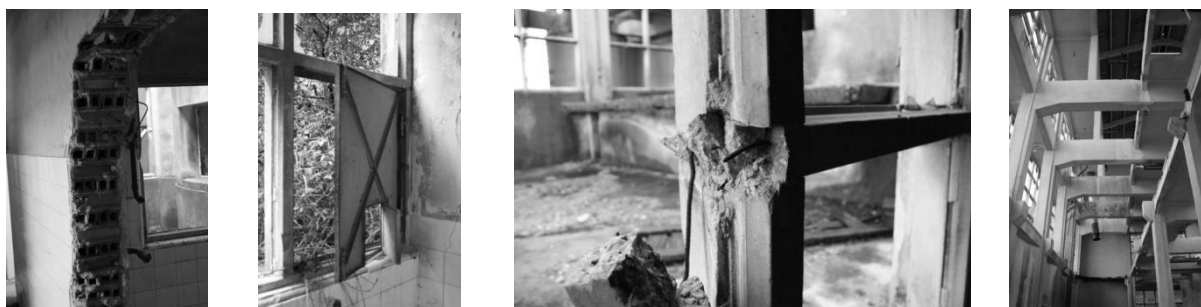
Fig. 9- Recolha de imagens do local de intervenção, respetivamente, i1 alvenaria de tijolo furado, i2 Elementos metálicos para encerramento parcial de vão, i3 caixilharia tipo 'Gracifer', i4 estrutura de betão armado pilar viga, fotografia do autor.
