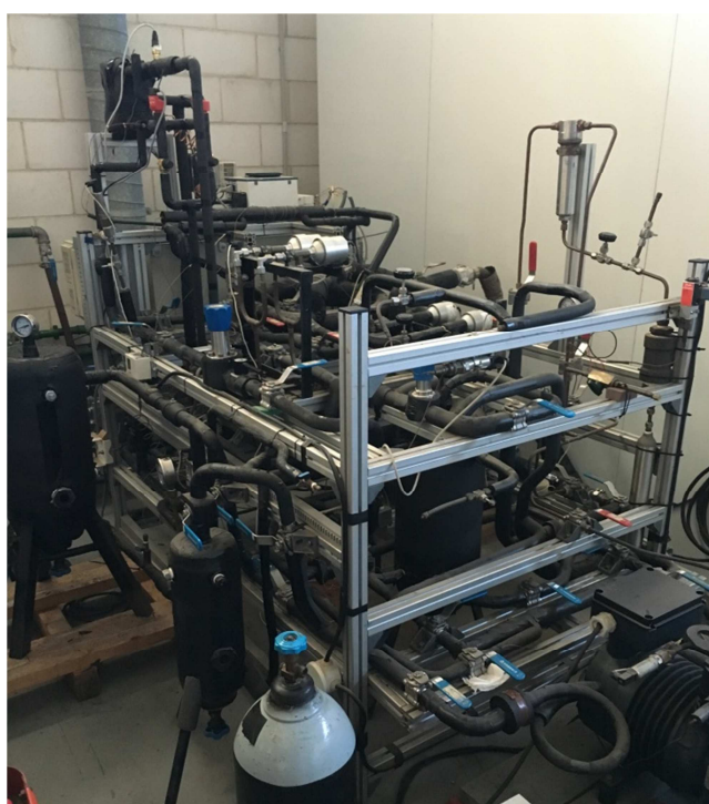
Fig. 14 – Instal·lació de CO 2 transcíctic.
