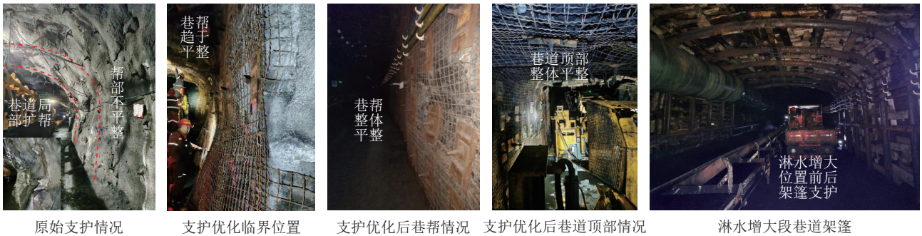
图 16 防治措施应用前后现场巷道情况
