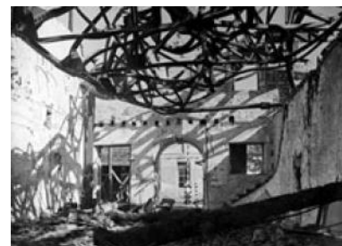
Figura 58: Edifício parcialmente destruído. Fonte: Service Historique de la Marine de Rochefort http://www.ordiecole.com/cordages.pdf [Consult. 20 Maio 2011].
