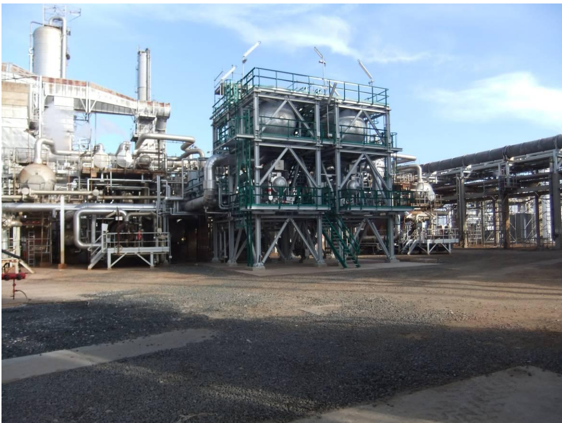
Figura 7.5 – Unidade de recuperação de enxofre na Unidade de Fabricação I com a integração do estágio SUPERCLAUS® (SS – A/B)
