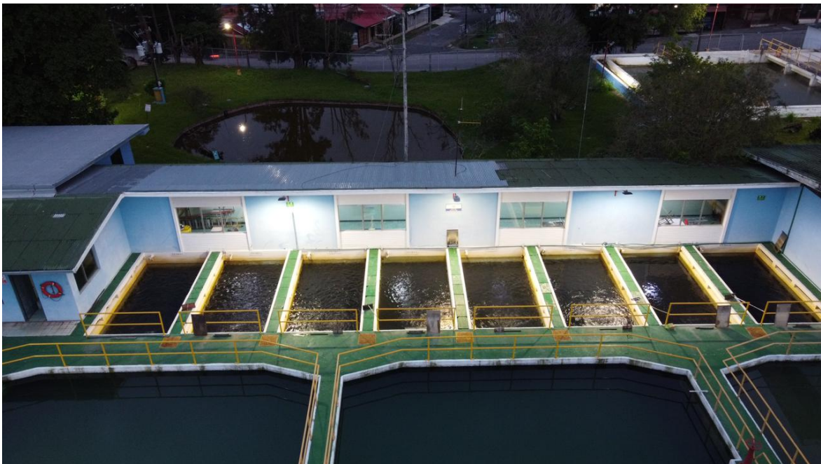
Fig. 2.9. Sistema de filtración de la Planta Potabilizadora AyA Guadalupe.
