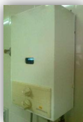
Imagen 40. Calentador de gas butano de la vivienda 1. Fuente Propia
