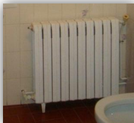
Imagen 39. Radiadores de la vivienda 1. Fuente Propia
