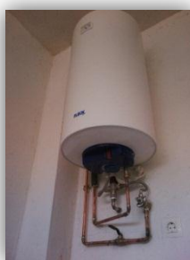
Imagen 61. Calentador eléctrico de la vivienda 3. Fuente Propia
