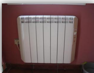
Imagen 60. Radiadores de la vivienda 3. Fuente Propia
