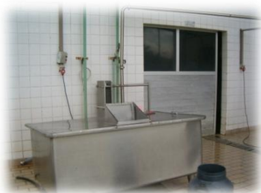
Figura 8 – Equipamento de filtração.
