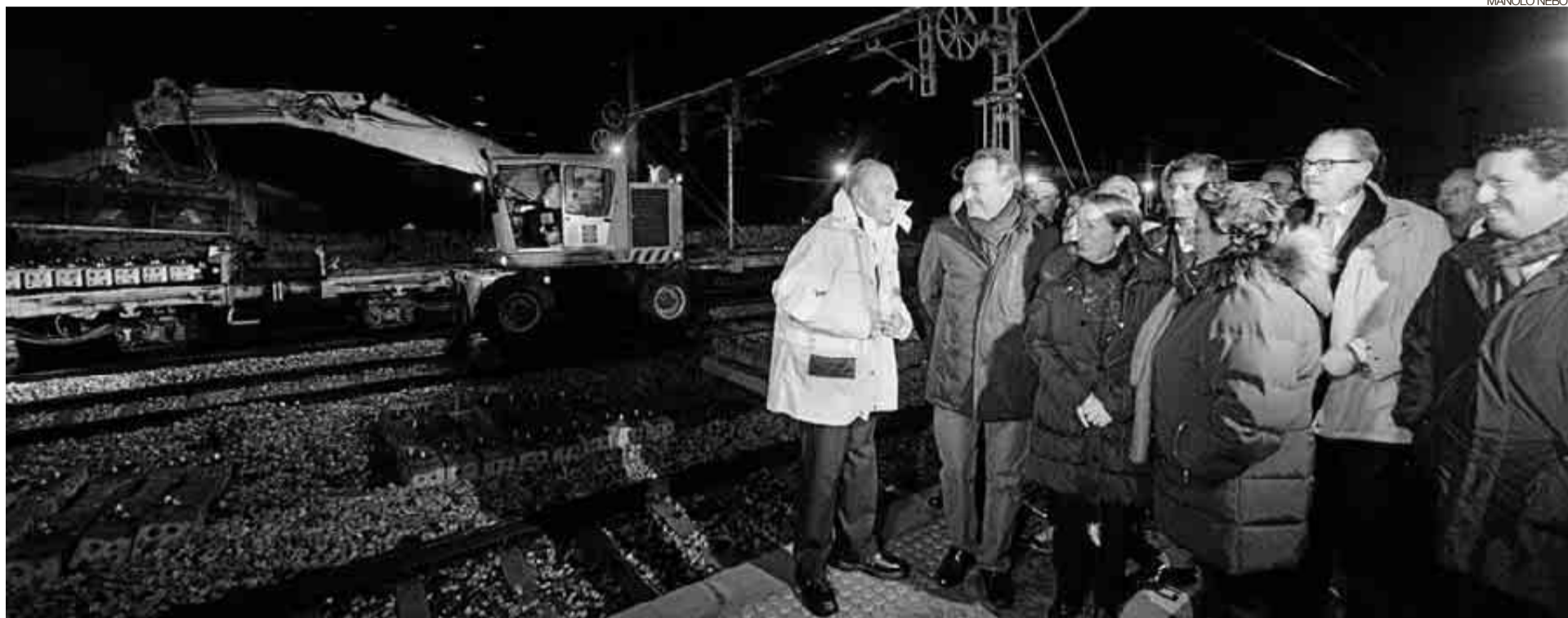
► El presidente de Adif, el de la Generalitat, la ministra de Fomento, el alcalde de Castellón, la alcaldesa de Valencia y el presidente de la Diputación, en las obras en Massalfassar.
