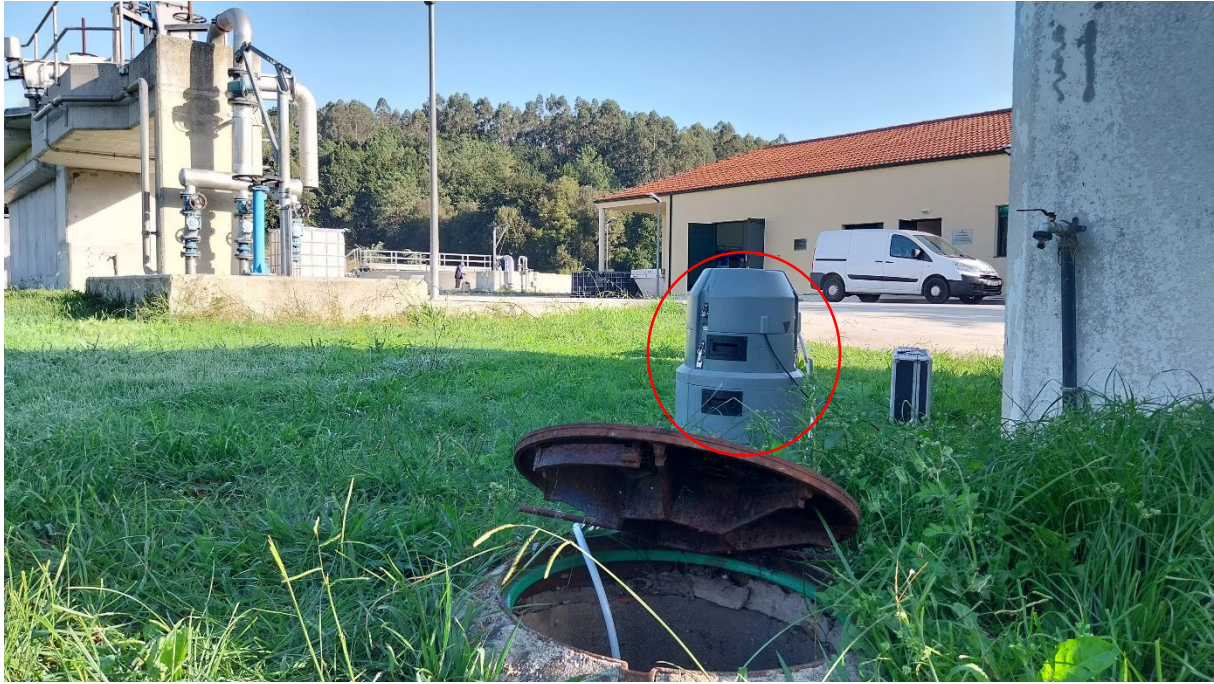
Figura 5.2.- Equipo automático instalado para tomar muestras del afluente a la EDAR de Carral desde el pozo de llegada de agua bruta.
