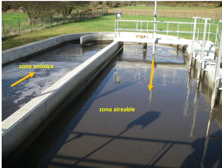
Figura 4.10.- Imagen del canal de oxidación (EDAR de Carral). A la izquierda zona sin aireación. A la derecha tramo aireable (aireación intermitente con difusores de fondo). Las flecha indican el sentido de circulación del licor mezcla.
