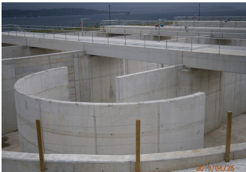
Figura 2.14. Paredes guía del canal de oxidación de la EDAR de Ares.
