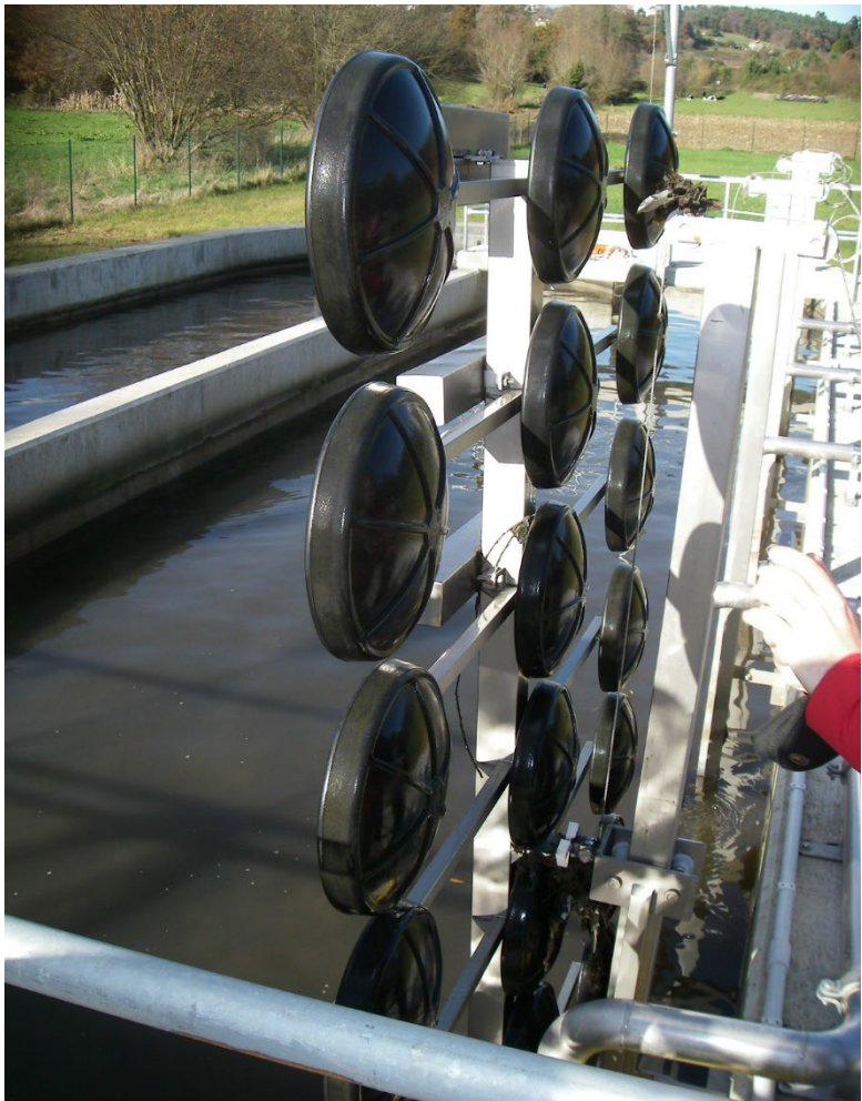
Figura 2.11. Difusores de aire de membrana con sistema de extracción mecanizada para facilitar las tareas de mantenimiento (EDAR de Carral).
