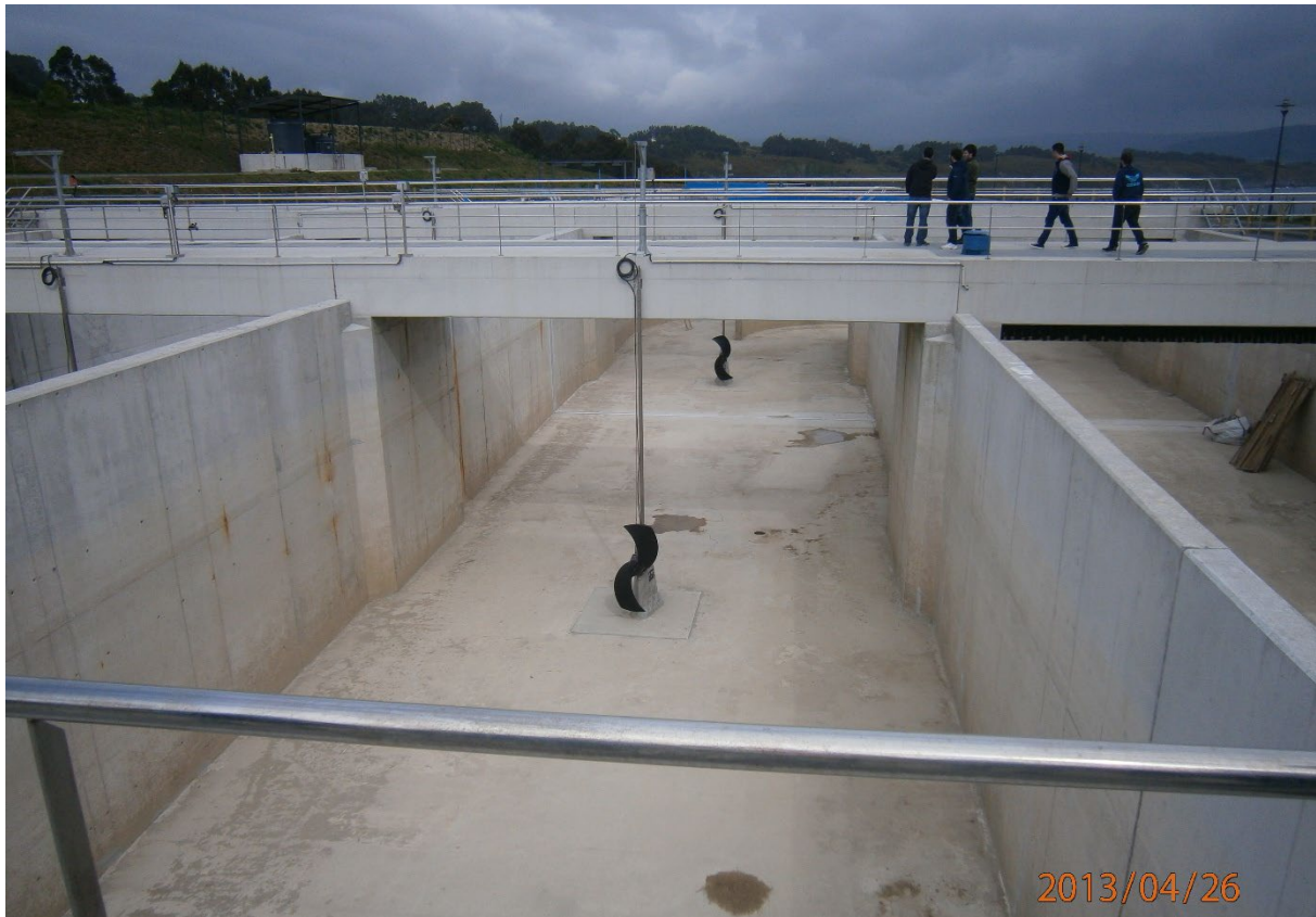
Figura 2.12. Aceleradores de velocidad del flujo, con forma de hélice (EDAR de Ares).
