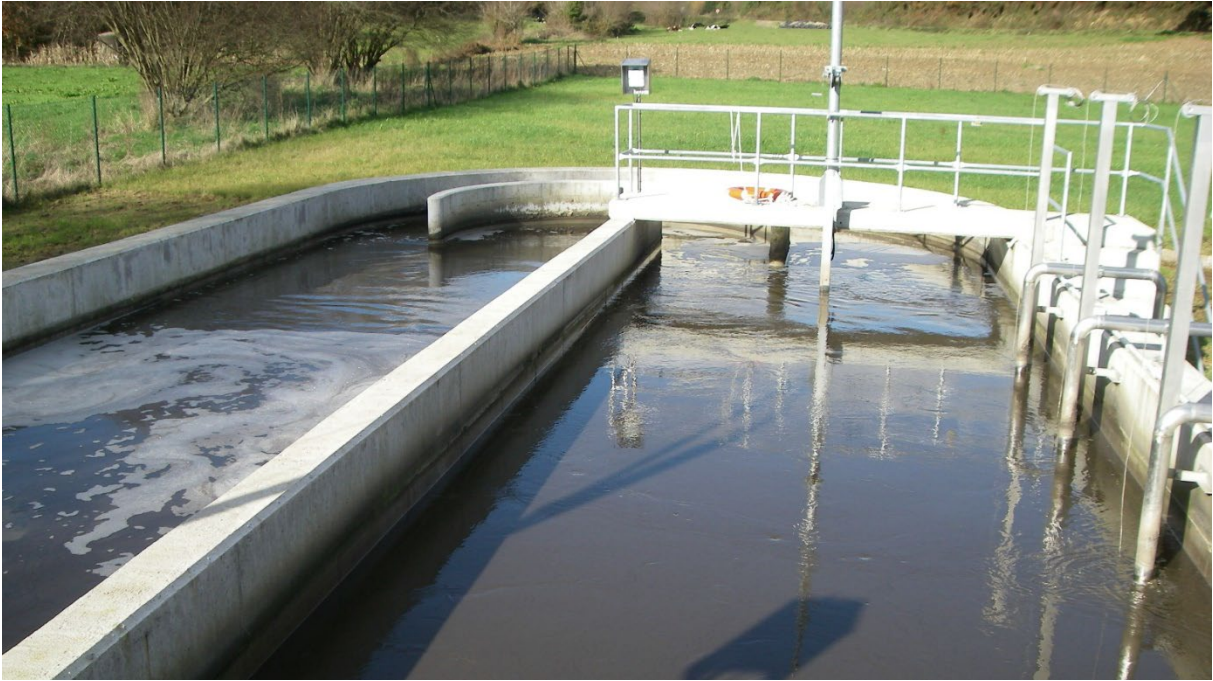
Figura 2.10. Canal dotado de difusores de aire de funcionamiento intermitente (EDAR-Carral).
