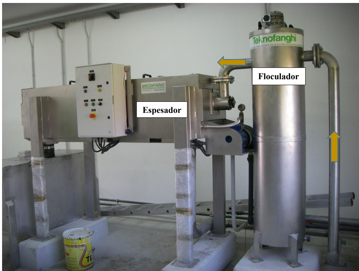
Figura 4.15.- Espesador dinámico y tanque cilíndrico de floculación previa.
