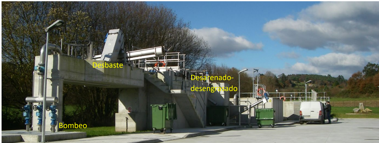
Figura 4.6.- Imagen de la etapa de pretratamiento de la EDAR de Carral.
