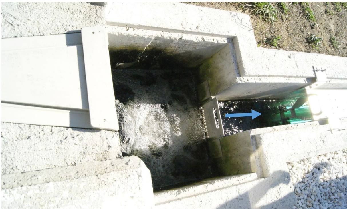
Figura 4.14.- Imagen de la zona de entrada al canal de desinfección UV (EDAR de Carral).
