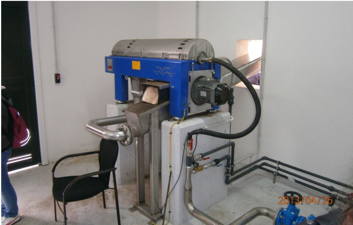
Figura 4.16.- Centrífuga de deshidratación de lodos de la EDAR de Carral.
