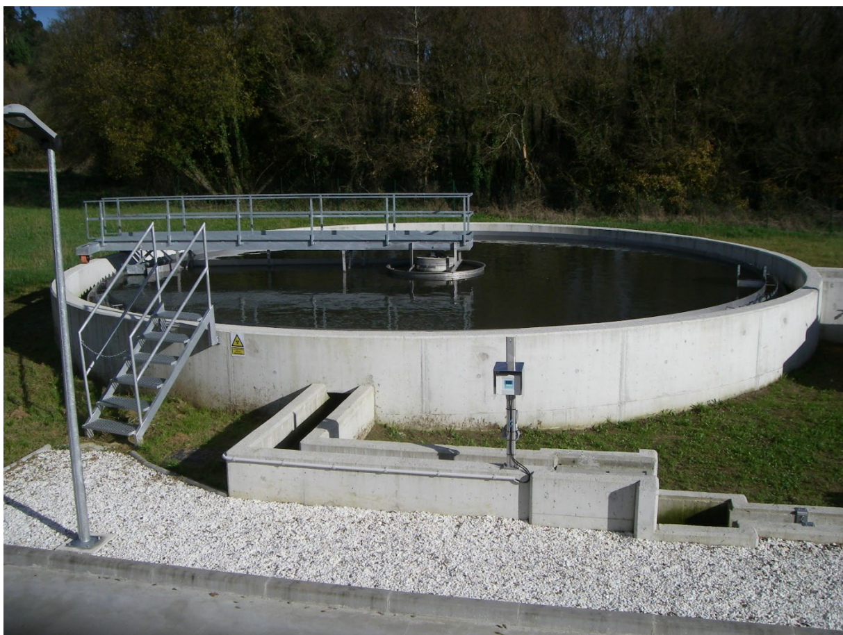
Figura 4.12.- Imagen del decantador secundario (EDAR de Carral).
