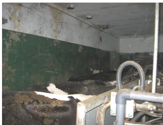
Figura 11: Sala de ordenha da explo. C, com fendas e sujidade nas paredes (Original, 2009).
