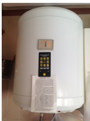
Ilustración 40. Termo eléctrico en vivienda
