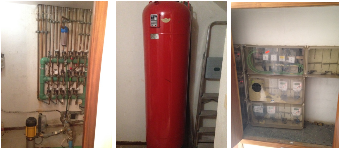
Ilustración 135. Cuarto de bombas
