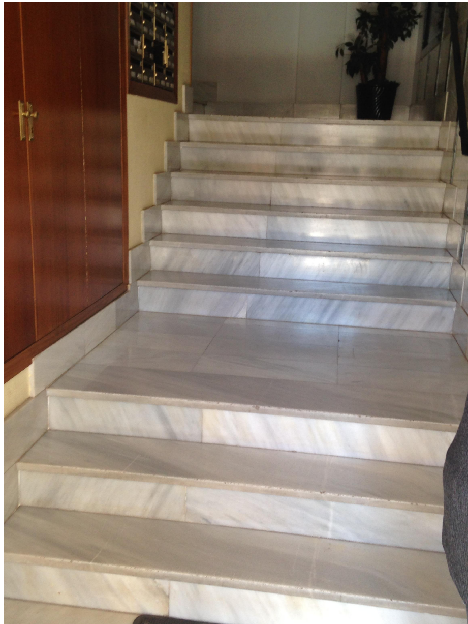
Accesibilidad. Existencia de desnivel [Ref. AC001]
