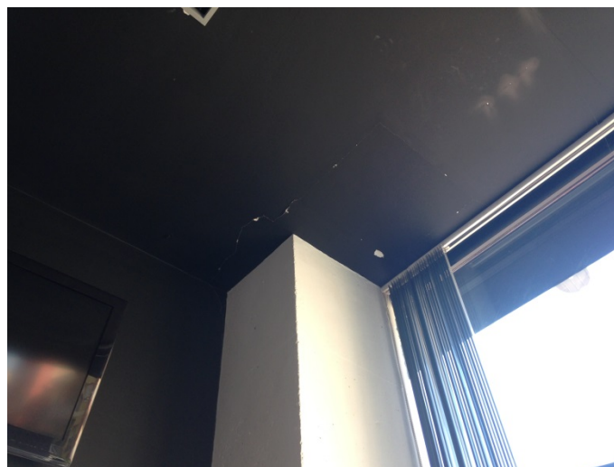
Ilustración 134. Deficiencias falso techo
