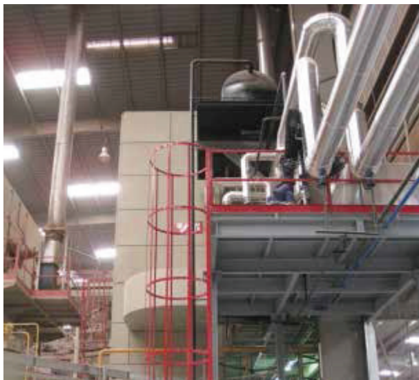
Figura 6 Chegada da conduta de óleo térmico ao secador
