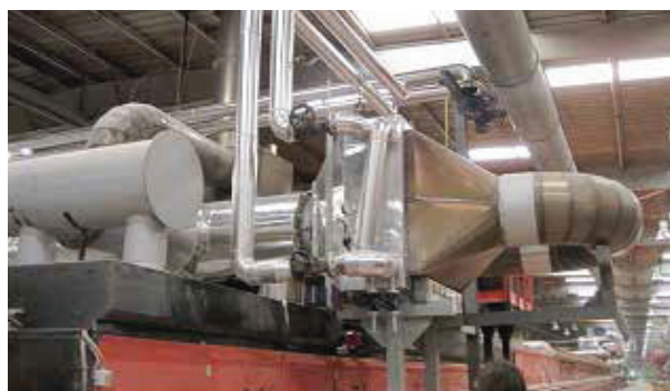
Figura 7 Permutador óleo/ar na chaminé dos gases de combustão
