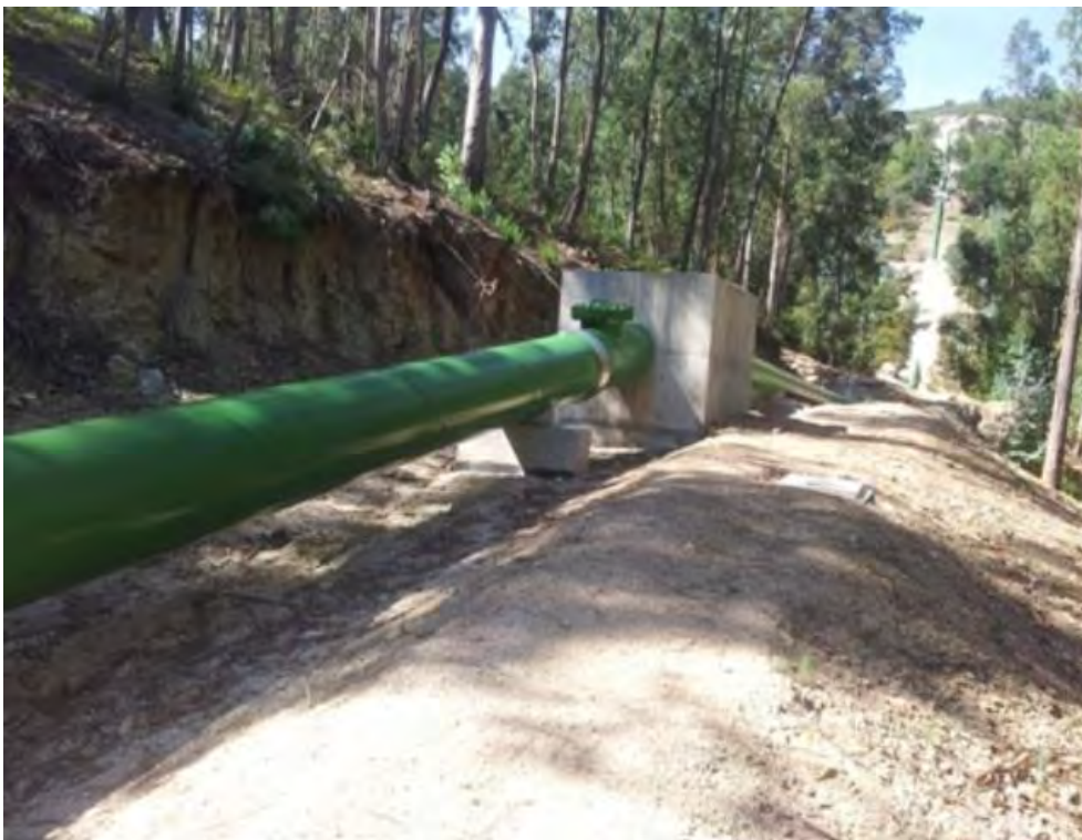
Figura 6 - Condução forçada do aproveitamento hidroelétrico de Agilde (Portugal) (Metaloespo, 2011)
