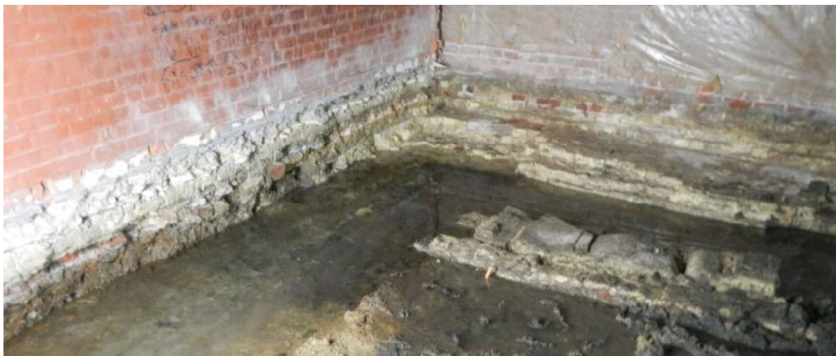
Figuur 3: Wateroverlast door de hoge grondwatertafel in de noordoostelijke hoek van de eerste kelder (WP1) (© agentschap Onroerend Erfgoed).
