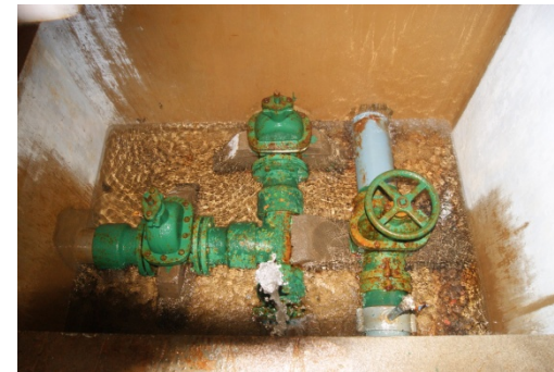
Figura VI: Saída de água para o reservatório da cidade pela tubagem à direita..
