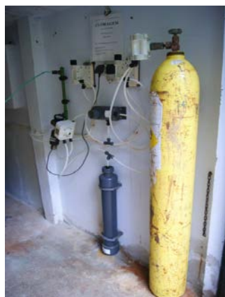
Figura 6 - Clorómetro e garrafa de reserva de cloro gasoso.
