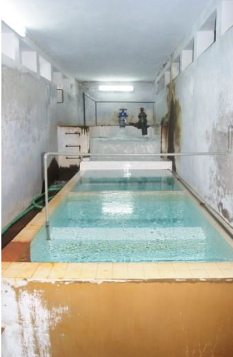
Figura II: Camaras de arejamento e Câmara de contacto de cloro da ETA da Nasce Água.
