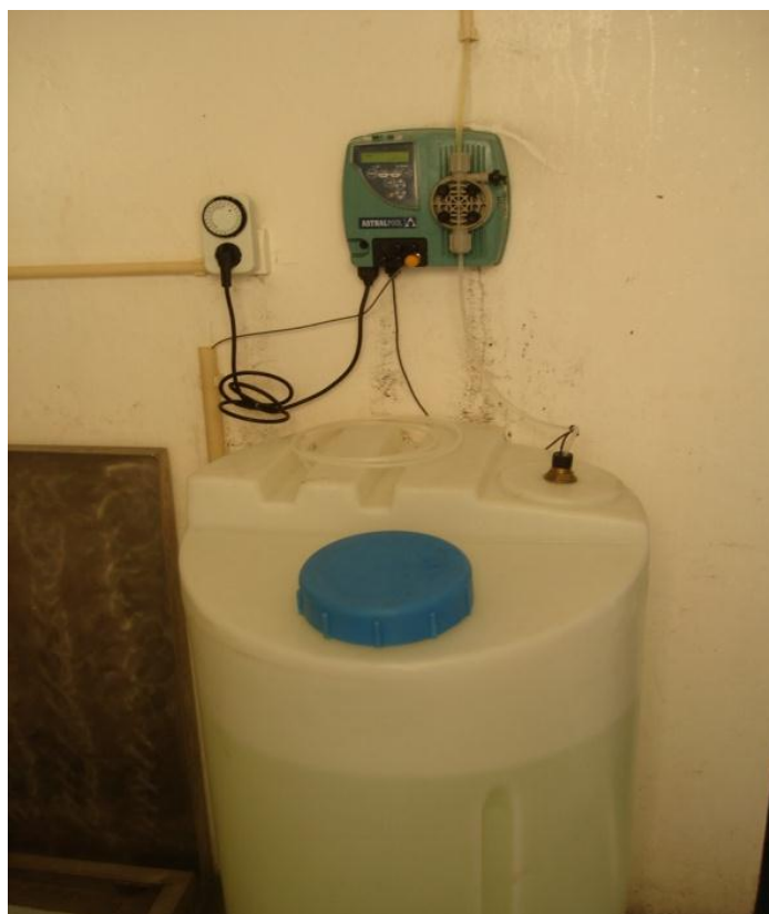
Figura 4.8 - Sistema automático de adição de hipoclorito de sódio (concelho da Povoação).
