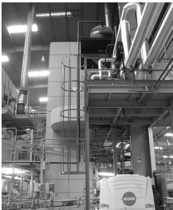
Figura 5. Conducto calorifugado que transporta el aceite térmico hacia el secadero (arriba) y llegada del conducto de aceite térmico al secadero (abajo).
