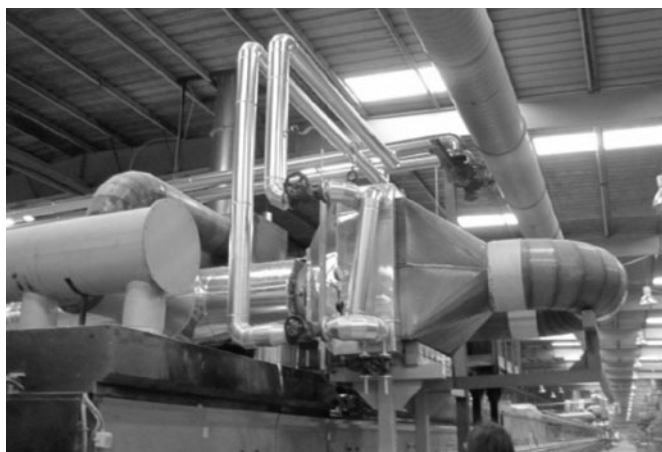
Figura 6. Intercambiador aceite/aire en la chimenea de los gases de combustión.
