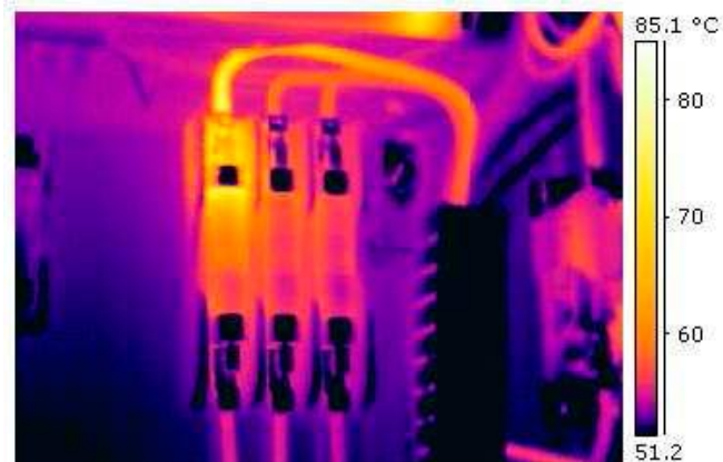
Figura 2.33: La termografia permet mesurar la temperatura superficial d'un sistema analitzant la radiació electromagnètica que emet. La figura mostra la imatge d'uns fusibles industrials, un dels quals presenta una temperatura superior a la resta. Això pot provocar la seua fallida en un futur proper.
