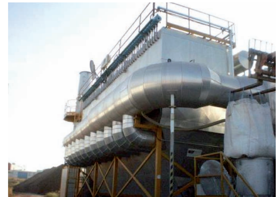
Figura 3. Vista general del filtro de mangas.
