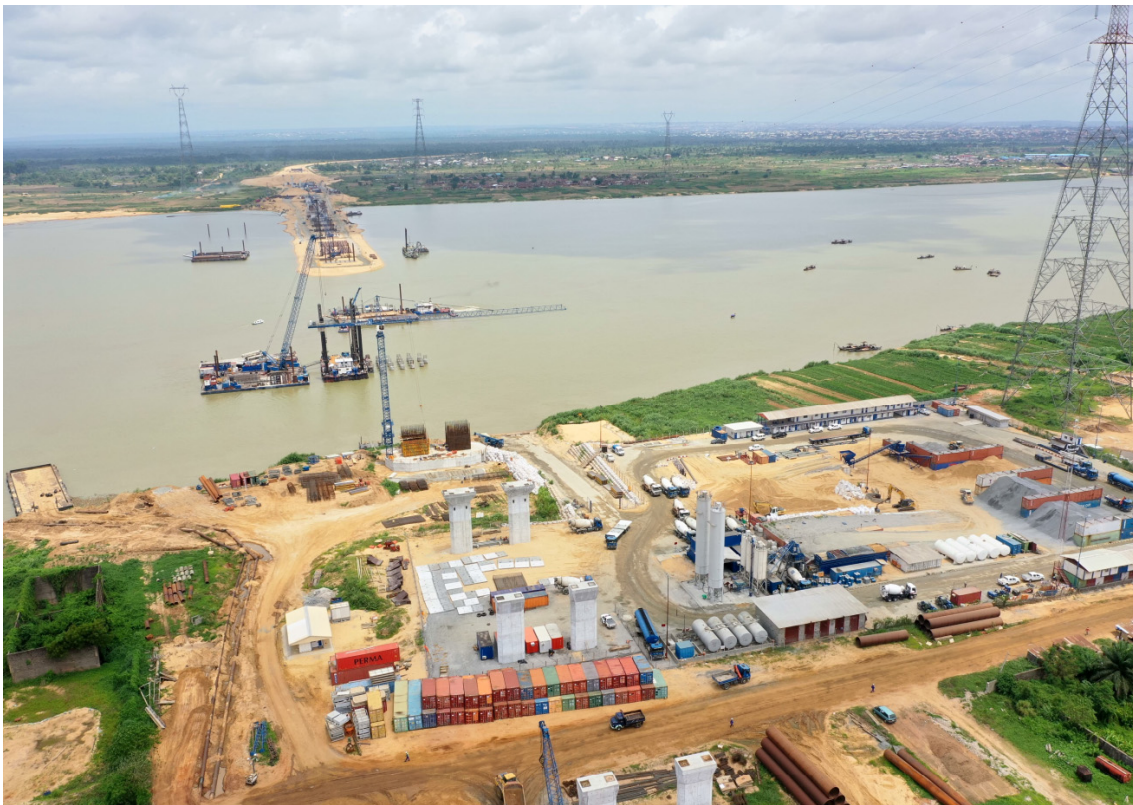
Bild 5 Vordergrund: fertige Brückenpfeiler der östlichen Vorlandbrücke Bildmitte: Herstellung der Großbohrpfähle mit Schwimmpontons Bildhintergrund: Herstellung der Rammpfähle vom Sanddamm
