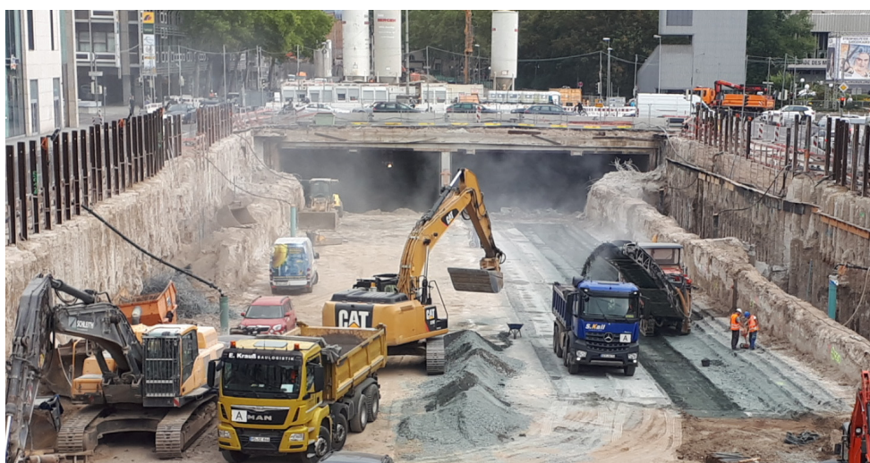
Bild 5 Abbruch der bestehenden Unterführung Ettlinger Tor im Zuge des Aushubs im Bauabschnitt W3 und W4
