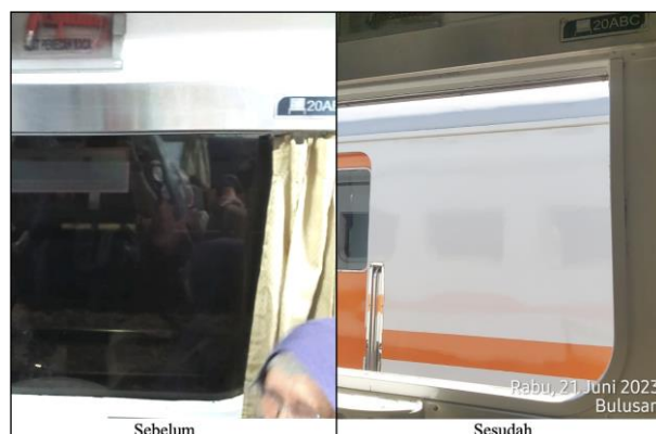
Gambar 4. Sampel temuan fisik ketidaksesuaian layanan KA PSO antarkota terhadap SPM dan tindak lanjut periode Triwulan II (kaca jendela pada KA Probwangi yang retak dan telah diganti)
