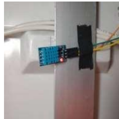
b) Sensor de temperatura. Figura 3. Control de la temperatura. Fuente: Elaboración propia.
