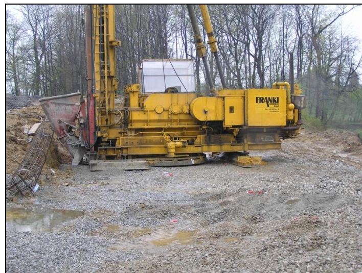
Silnice I/11 Český Těšín – obchvat, I. stavba, zakládání mostu SO 201 na FRANKI pilotách
