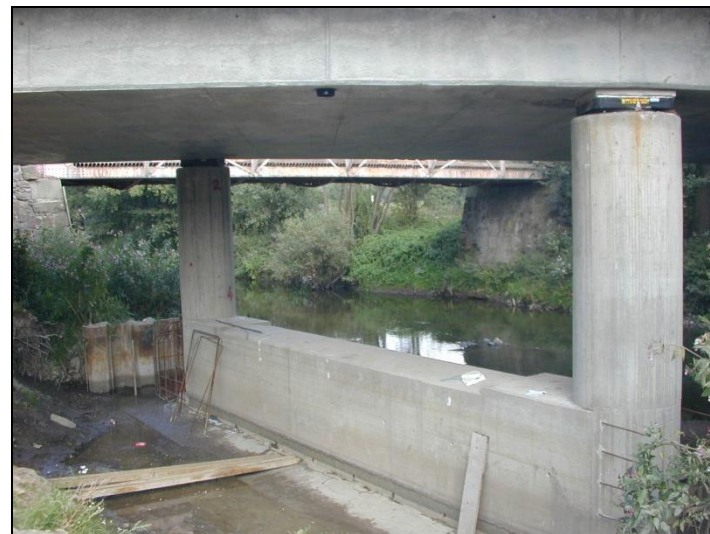
Hoštejn – most přes Moravskou Sázavu, střední pilíř byl založen na sloupech tryskové injektáže a po zatížení došlo k jeho poruše (06/2000)
