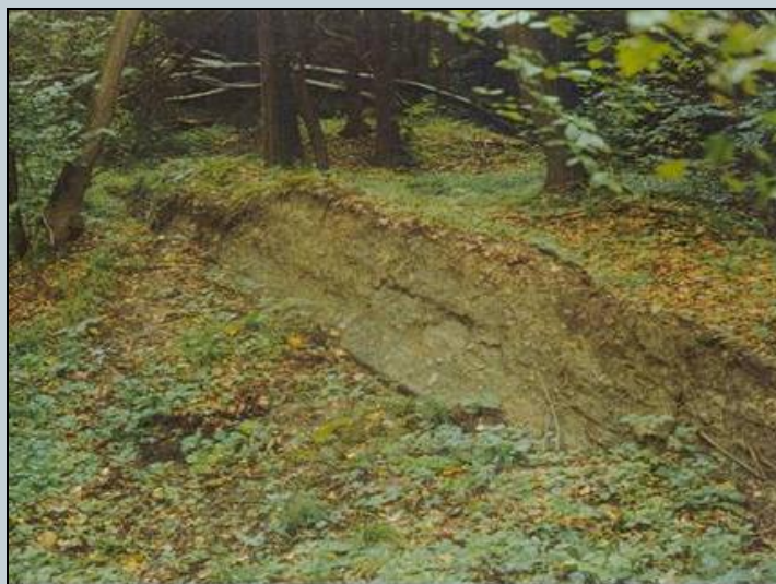
Smyková trhlina s výrazným horizontálním posunem; sesuv Vidče - Háje, 08/1997
