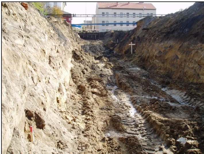
Žst. Břeclav – neupravená základová spára pod podchodem (2008)
