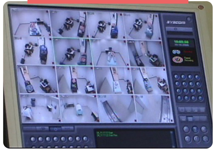
Figura 11 Sala de control con acceso a todas las dependencias.
