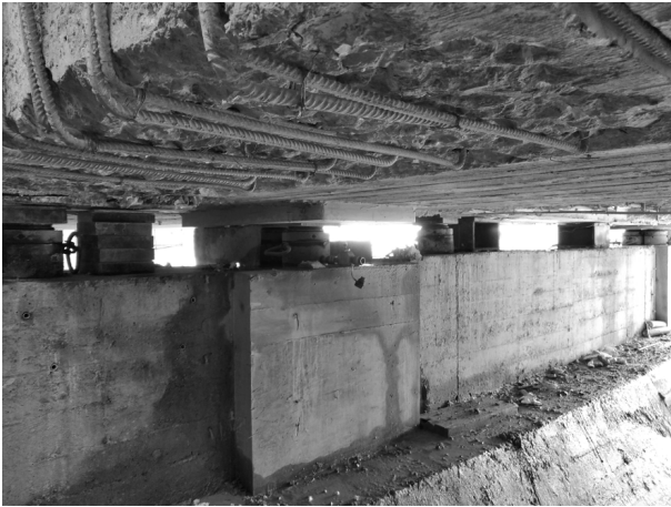
Figure 14. New support devices placed on the P30 pier / Nuovi dispositivi di appoggio su pila P30.
