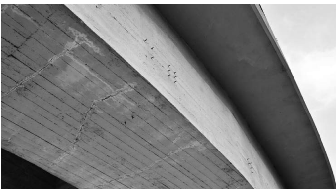
Figure 2. Cracks in the reinforced concrete sub-slab / Fessurazioni nella controsoletta in c.a..
