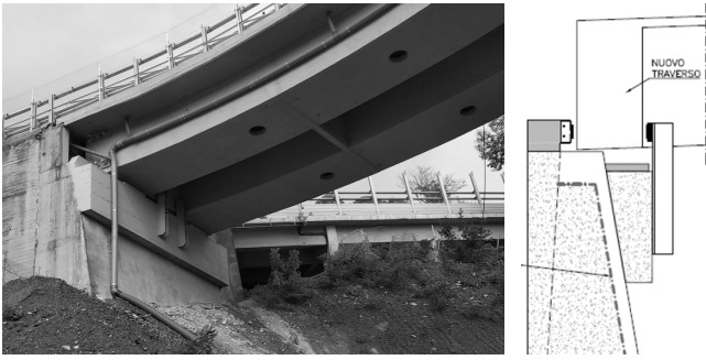
Figure 13. New support devices placed on the SP18 abutment / Nuovi dispositivi di appoggio su spalla SP18.
