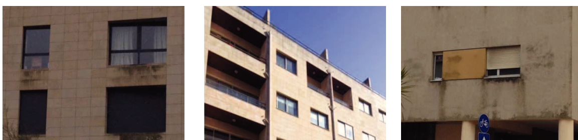
Figura 4.2 – Manchas em fachadas – edifícios em Matosinhos - Porto.
