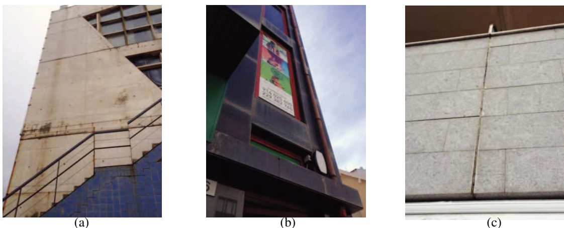
Figura 4.4 Envelhecimento acelerado da fachada (a) e degradação das juntas em edifícios em Matosinhos (b) e (c).
