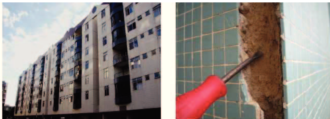
Figura 2.5 – Registo fotográfico do edifício e da anomalia (Bauer et al. , 2010).
