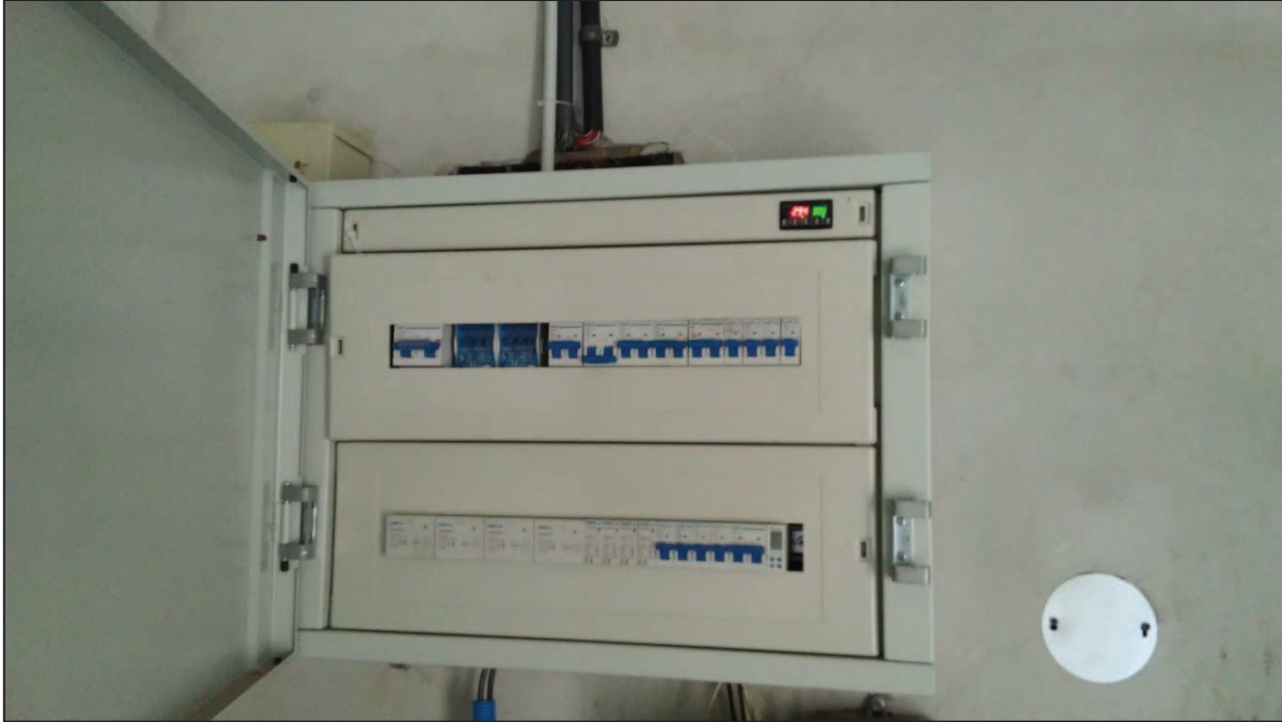
Figura 4.2. Tablero 2 (Fuente: Tomado en el lugar del Proyecto)
