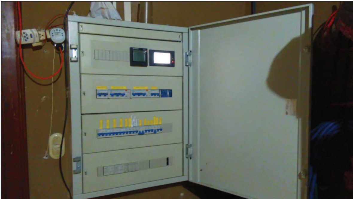
Figura 4.1. Tablero 1 (Fuente: Tomado en el lugar de Proyecto)
