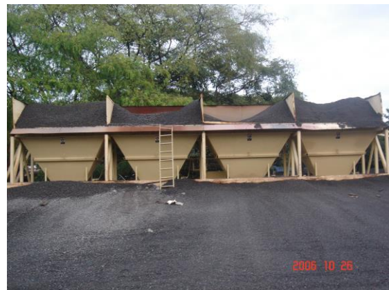
Figura 6. Tolvas de dosificación del agregado.
