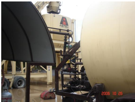
Figura 3. Tubería de conducción del asfalto hacia el tambor mezclador.
