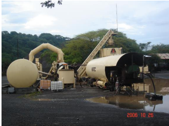
Figura 1. Bomba de succión hacia el tanque de almacenamiento del asfalto.
