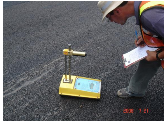
Figura 11. Toma de la densidad en sitio de la mezcla asfáltica con látex UP70SBR.
