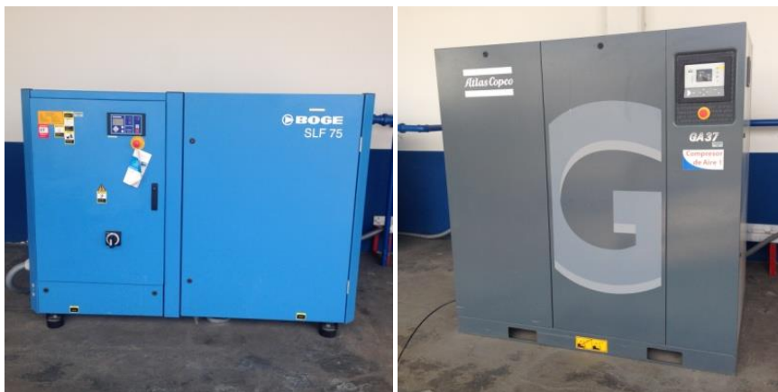
Figura 2.3. Compresores de aire.
