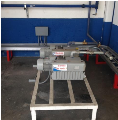
Figura 2.2. Bombas de vacío.
