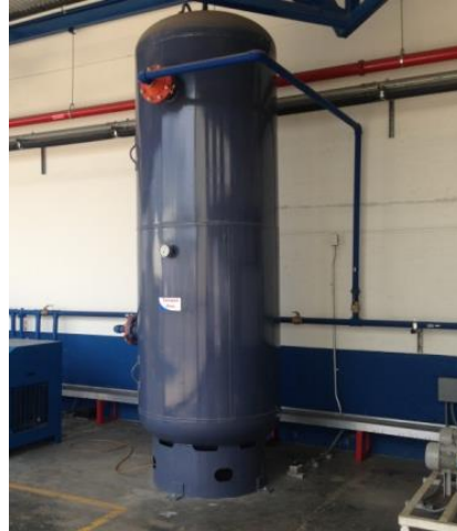
Figura 2.5. Tanque de aire comprimido.
