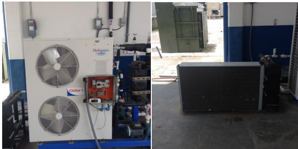
Figura 2.6. Chiller 1 y chiller 2 respectivamente.
