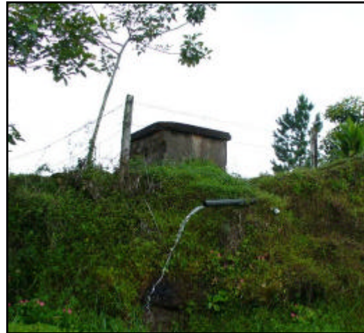
Figura 11. Foto del rebalse en tanque quebra gradiente (Fuente: La autora)
