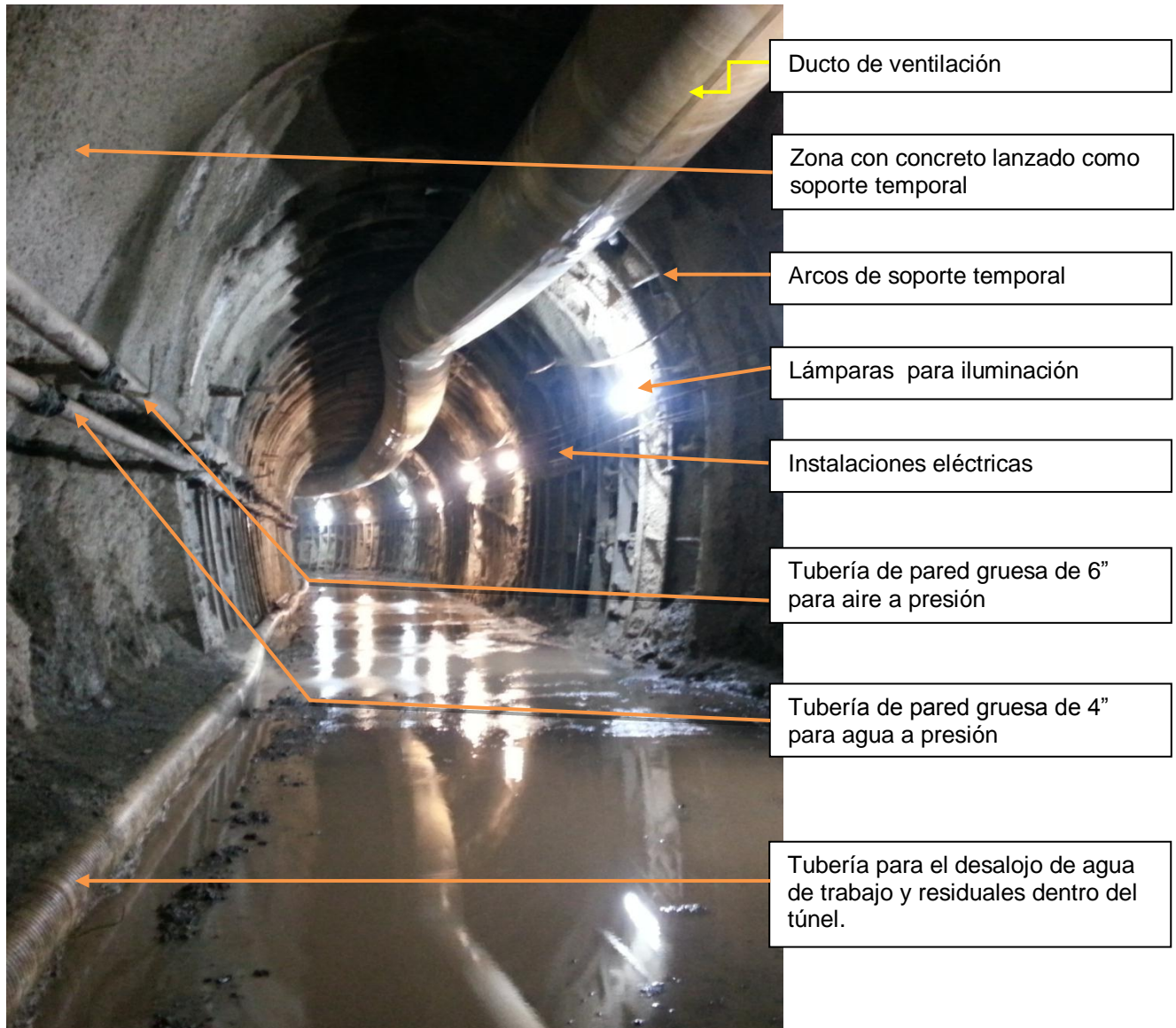
Figura # 25. Túnel de conducción Principal del PHBI en etapa preliminar al revestimiento. (PHBI, 2012).
