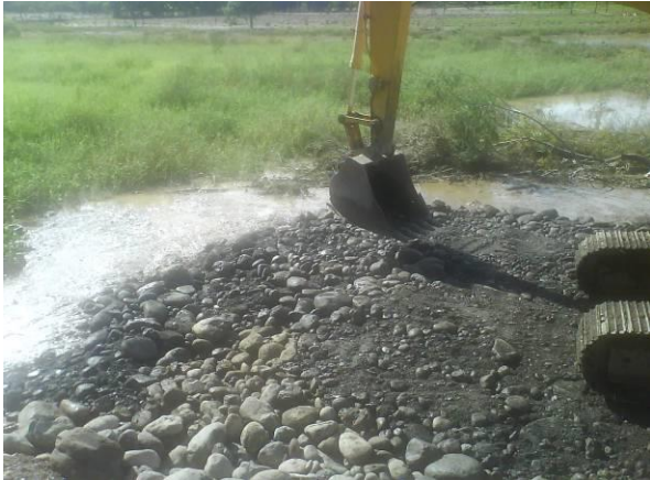
Imagen 24. Sustitución de piso y ampliación de andén en sitio conocido como la laguna.
