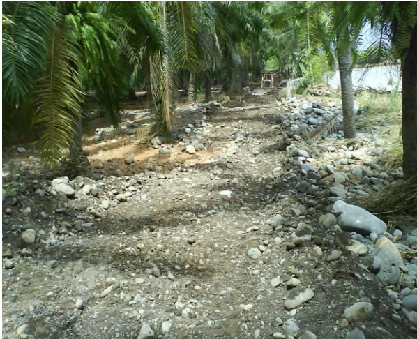
Imagen 13 Trabajos de reconstrucción tras el paso de la Tormenta Tropical Alma en el Sector de la Bomba de Agua o sección 2.
