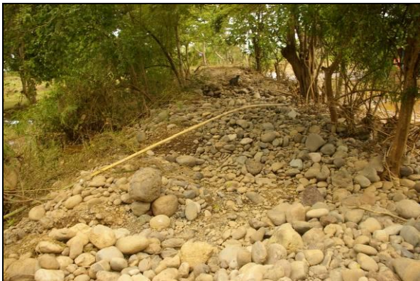
Imagen 18 Fotografía de daños en la sección de dique de Sitradique, al fondo de la imagen se resalta las dimensiones existentes posteriores a los eventos.
