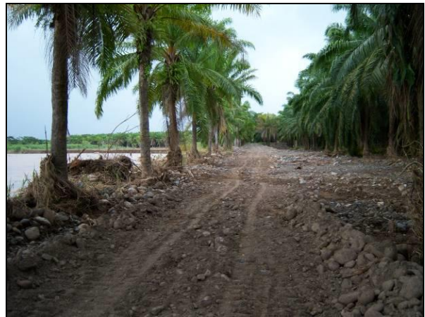
Imagen 25. Fotografía de la sección dos al inicio de las labores. Situación que resalta las condiciones de la estructura anterior.
