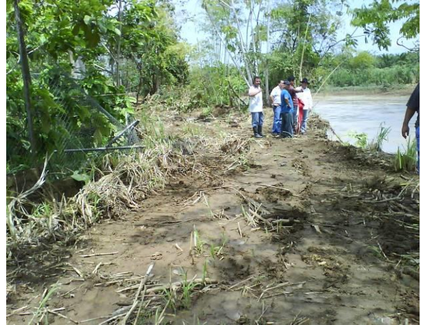
Imagen 14 Inspección realizada al sector ubicado detrás del plantel del MOPT un día después del paso del fenómeno atmosférico.
