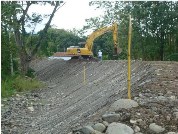
Imagen 27. Fotografía de la conformación final del talud del lado húmedo en la estructura de Parrita Centro.
