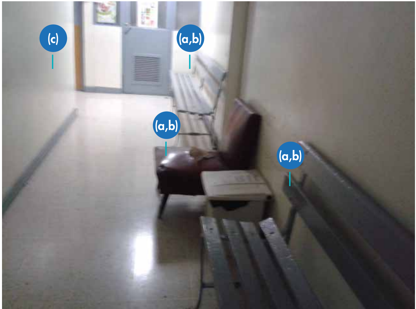
Figura 35_ Problemas / área gineco obstetra 2
