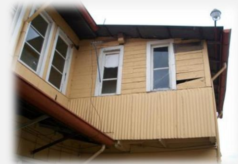
Ilustración 4: Daños en las estructuras de madera
