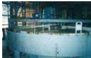
Figura #8. Clarificador de Meladura
