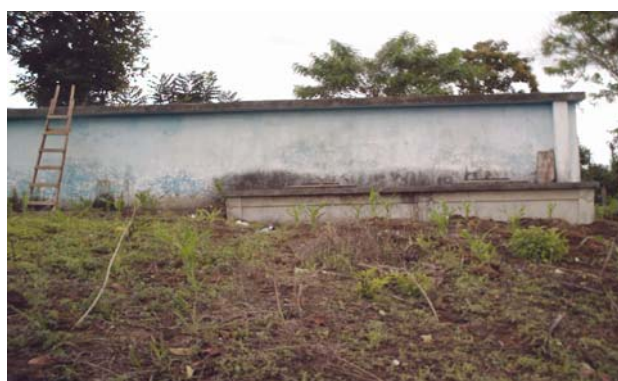
Tanque de almacenamiento 300m 3
