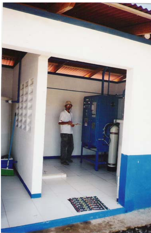
Caseta de Cloración
