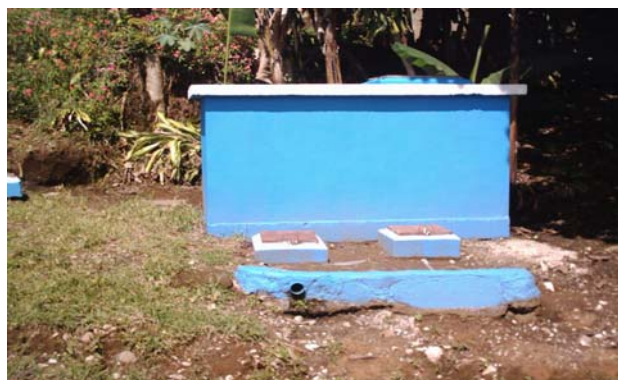
Tanque Quebragradiente 2m 3
