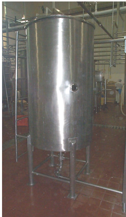
Figura # 9 Tanque de almacenamiento
