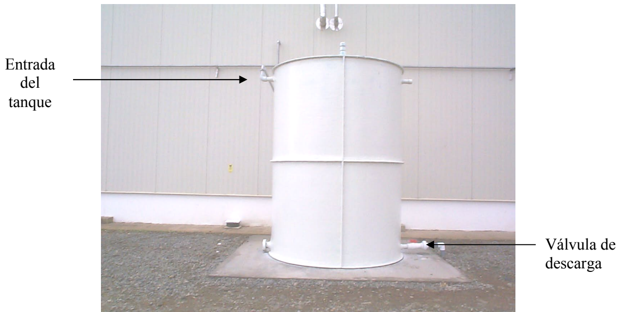
Figura #13 Tanque de descarga controlada
