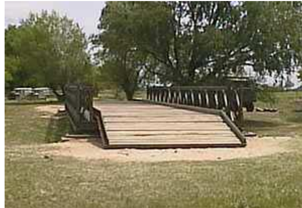
Fig. N° 5: Vista de un puente a base de armaduras con piso inferior y tablero de madera. MSPAINT
